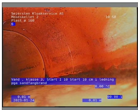
Foto: 11_1_1_24012023_075733_1.JPG 0,01m, Vand, klasse 3 / Start I 10 Start 10 cm i ledning pga sandfangbrønd
