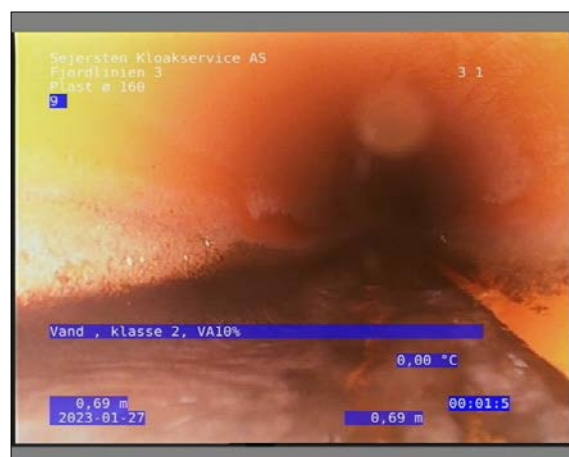
Foto: 25_1_5_27012023_084452_1.JPG 0,69m, Vand, klasse 2 / VA10%
