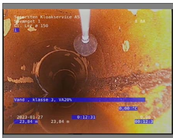
Foto: 28_1_30_27012023_104422_1.JPG 23,84m, Vand, klasse 3 / VA20%
