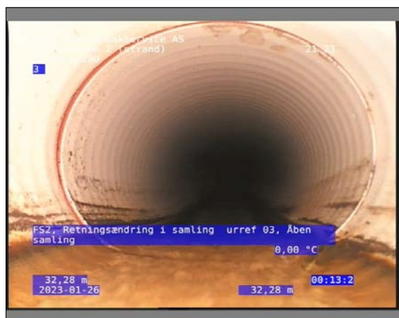
Foto: 22_1_18_26012023_082031_1.JPG 32,27m, FS2, Retningsændring i samling urref 03, Åben samling
