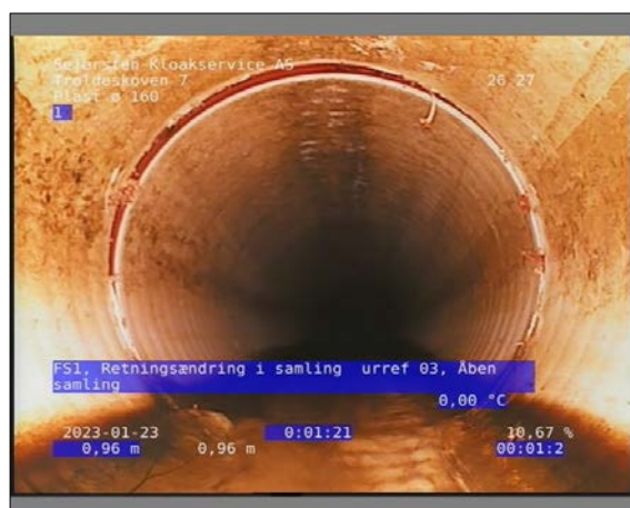
Foto: 10_1_5_23012023_144516_1.JPG 0,96m, FS1, Retningsændring i samling urref 03, Åben samling
