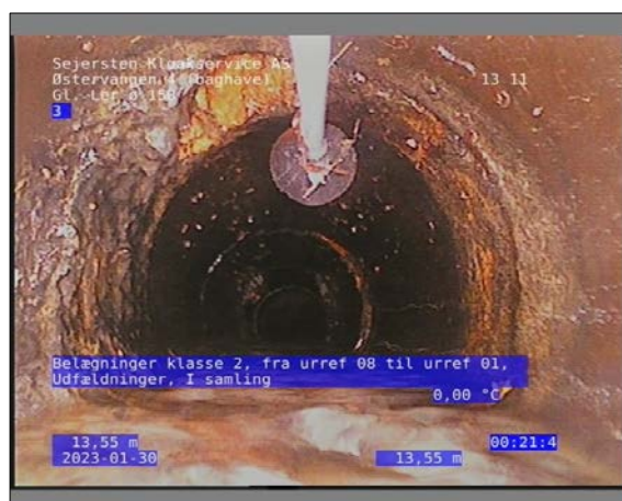
Foto: 31_1_38_30012023_143721_1.JPG 13,55m, Belægninger klasse 2, fra urref 08 til urref 01, Udfældninger, I samling
