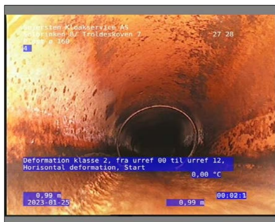
Foto: 20_1_7_25012023_123405_1.JPG 0,99m, Deformation klasse 2, fra urref 00 til urref 12, Horizontal deformation, Start
