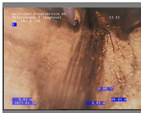
Foto: 31_1_7_30012023_140640_1.JPG 0,84m, Rørbrud klasse 3, fra urref 02 til urref 05, Sammensatte revner / Bundløb i urref 7 - vandflowet trekker sand ind fra rørbrud, Skønnet
