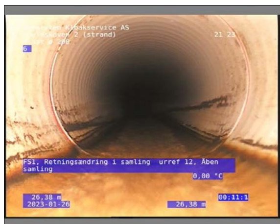
Foto: 22_1_12_26012023_081721_1.JPG 26,38m, FS1, Retningsændring i samling urref 12, Åben samling
