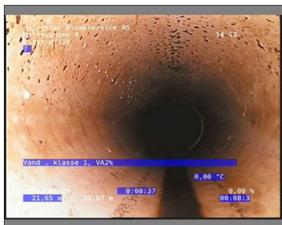
Foto: 14_1_18_24012023_114627_1.JPG 21,67m, Vand , klasse 1 / VA2%
