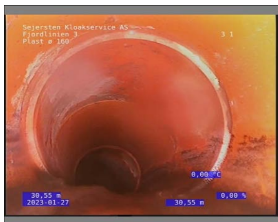
Foto: 25_1_14_27012023_085705_1.JPG 30,55m, FS3, Retningsændring i samling urref 07, Åben samling
