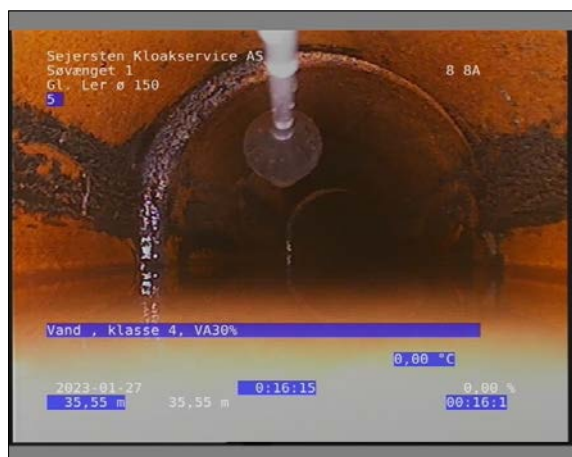
Foto: 28_1_38_27012023_105006_1.JPG 35,55m, Vand, klasse 4 / VA30%
