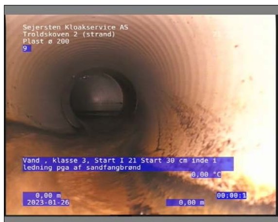
Foto: 22_1_1_26012023_080156_1.JPG 0m, Vand, klasse 3 / Start I 21 Start 30 cm inde i ledning pga af sandfangbrønd
