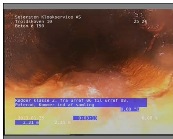
Foto: 21_1_7_25012023_133234_1.JPG 2,31m, Rødder klasse 2, fra urref 06 til urref 08, Pælerod / Kommer ind af samling
