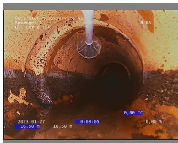
Foto: 28_1_21_27012023_103632_1.JPG 16,5m, FS3, Retningsændring i samling urref 03, Åben samling
