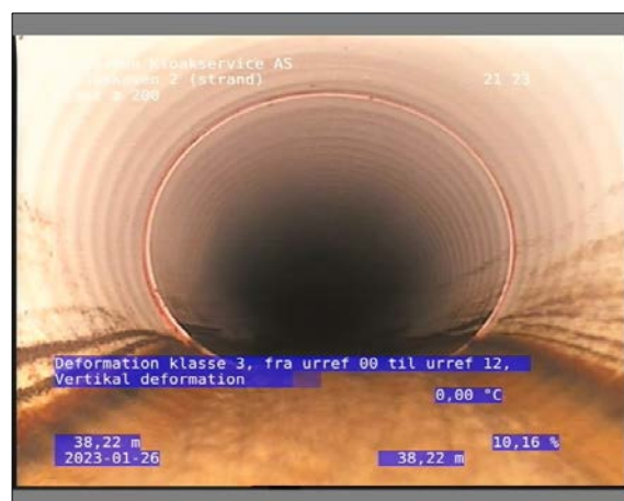
Foto: 22_1_21_26012023_082357_1.JPG 38,22m, Deformation klasse 3, fra urref 00 til urref 12, Vertikal deformation
