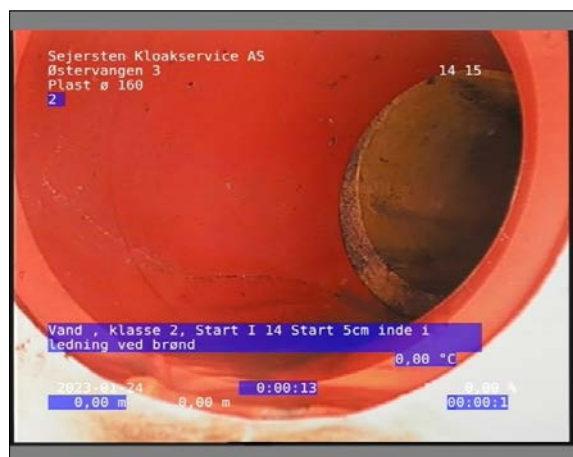
Foto: 13_1_1_24012023_095228_1.JPG Om, Vand , klasse 2 / Start I 14 Start 5cm inde i ledning ved brønd
