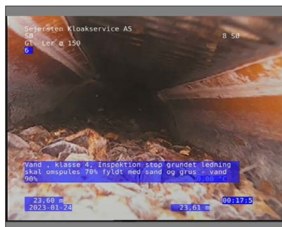
Foto: 16_1_21_24012023_142359_1.JPG 23,61m, Vand, klasse 4 / Inspektion stop grundet ledning skal ompules 70% fyldt med sand og grus - vand 90%
