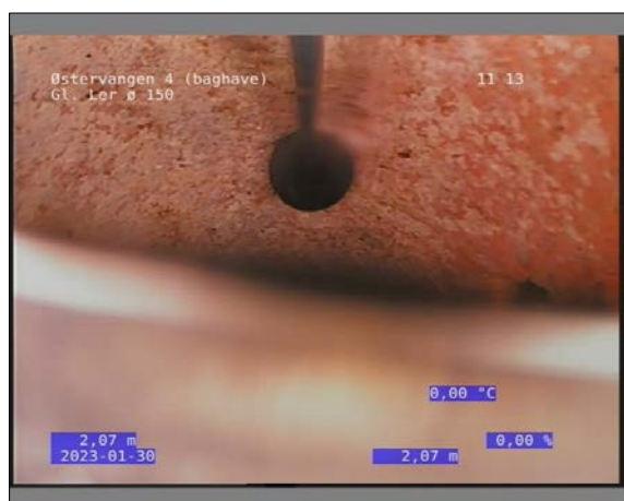
Foto: 30_1_12_30012023_130145_1.JPG 2,07m, Påhugget stik klasse 1, urref 03, Manglende forbindelse mellem stik/hovedledning / Kan kun skimte påhungen pga af meget vand i ledning
