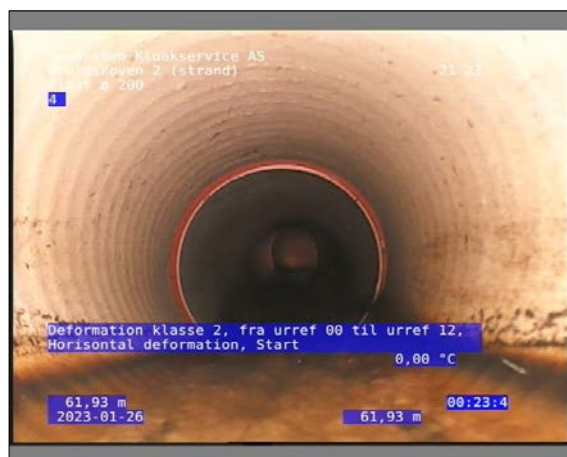
Foto: 22_1_32_26012023_083540_1.JPG 61,93m, Deformation klasse 2, fra urref 00 til urref 12, Horizontal deformation, Start
