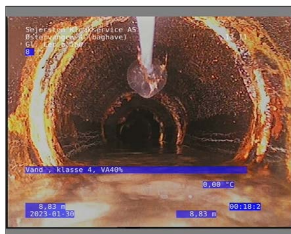
Foto: 31_1_29_30012023_143008_1.JPG 8,83m, Vand, klasse 4 / VA40%
