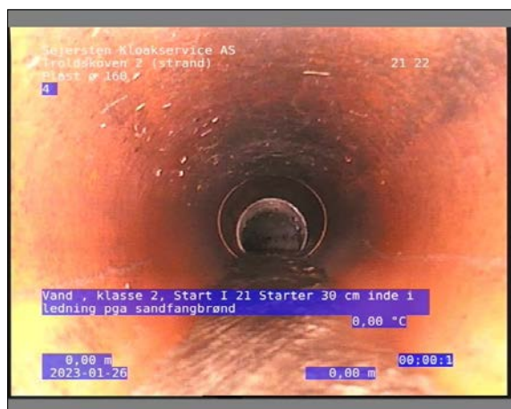
Foto: 23_1_1_26012023_093535_1.JPG 0m, Vand , klasse 2 / Start I 21 Starter 30 cm inde i ledning pga sandfangbrønd
