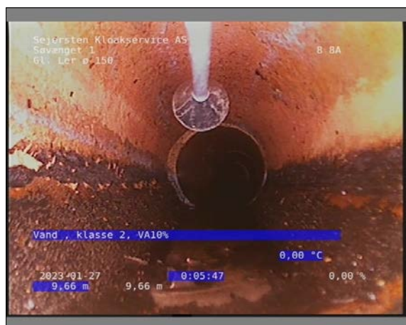
Foto: 28_1_14_27012023_103245_1.JPG 9,66m, Vand , klasse 2 / VA10%
