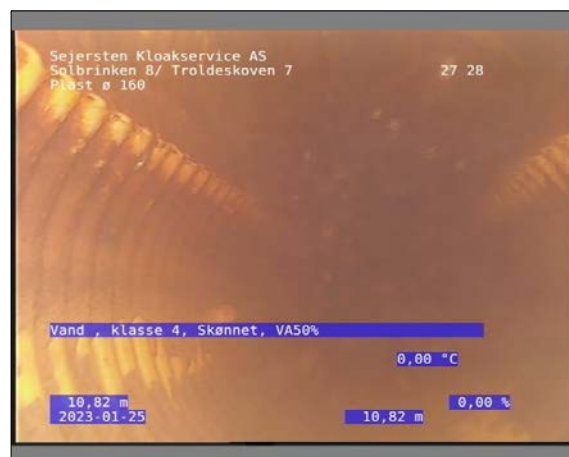
Foto: 20_1_13_25012023_124136_1.JPG 10,82m, Vand , klasse 4 / Skønnet, VA50%
