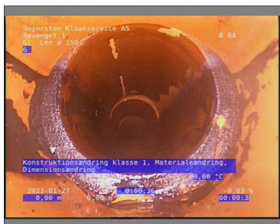
Foto: 27_1_4_27012023_100946_1.JPG 0,3m, Konstruktionsændring klasse 1, Materialeændring, Dimensionsændring
