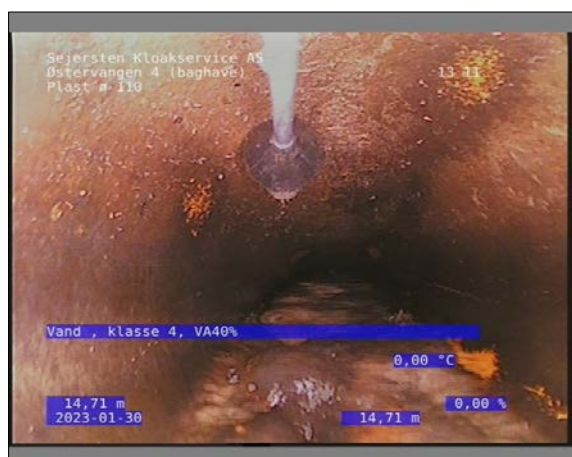
Foto: 31_1_42_30012023_144359_1.JPG 14,71m, Vand, klasse 4 / VA40%
