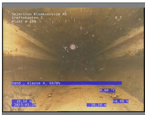
Foto: 4_1_21_20012023_103930_1.JPG 16,1m, Vand , klasse 4 / VA70%
