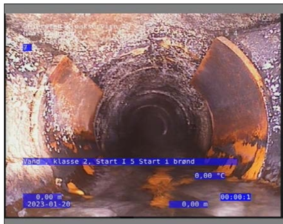
Foto: 3_1_1_20012023_093328_1.JPG 0m, Vand , klasse 2 / Start I 5 Start i brønd
