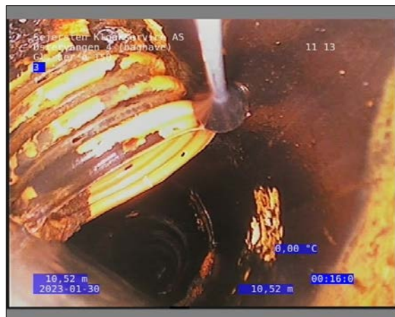
Foto: 30_1_22_30012023_131625_2.JPG 10,28m, Påhugget stik klasse 4, urref 09, Indragende stik, Manglende forbindelse mellem stik/hovedledning / Drænrør
