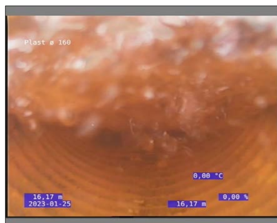
Foto: 20_1_15_25012023_124523_1.JPG 16,16m, Deformation klasse 3, fra urref 00 til urref 12, Vertikal deformation / Skønnet da kamera har svært ved at komme videre og kan kun se bunden af ledningen pga meget vandflow
