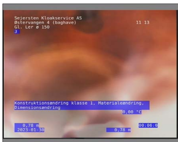
Foto: 30_1_4_30012023_125422_1.JPG 0,78m, Konstruktionsændring klasse 1, Materialeændring, Dimensionsændring
