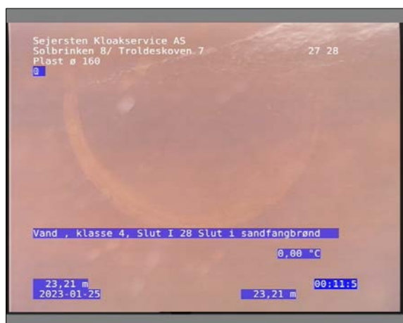
Foto: 20_1_23_25012023_125100_1.JPG 23,21m, Vand , klasse 4 / Slut I 28 Slut i sandfangbrønd
