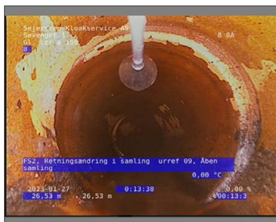
Foto: 28_1_33_27012023_104633_1.JPG 26,53m, FS2, Retningsændring i samling urref 09, Åben samling
