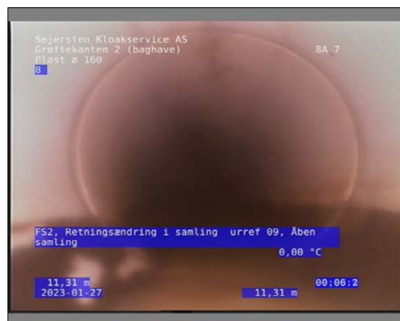
Foto: 26_1_12_27012023_093230_1.JPG 11,31m, FS2, Retningsændring i samling urref 09, Åben samling
