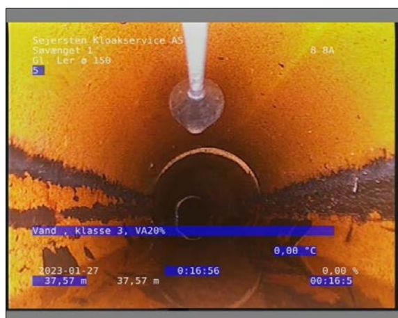
Foto: 28_1_40_27012023_105125_1.JPG 37,57m, Vand, klasse 3 / VA20%
