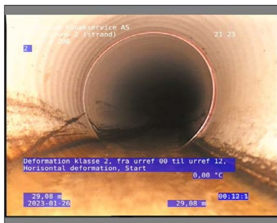
Foto: 22_1_14_26012023_081835_1.JPG 29,08m, Deformation klasse 2, fra urref 00 til urref 12, Horisontal deformation, Start
