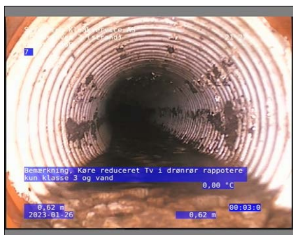
Foto: 23_1_7_26012023_094213_1.JPG 0,62m, Bemærkning / Køre reduceret Tv i drænrør rapportere kun klasse 3 og vand
