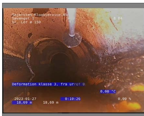
Foto: 28_1_25_27012023_104054_1.JPG 18,69m, Deformation klasse 3, fra urref 00 til urref 12, Knækdeformation
