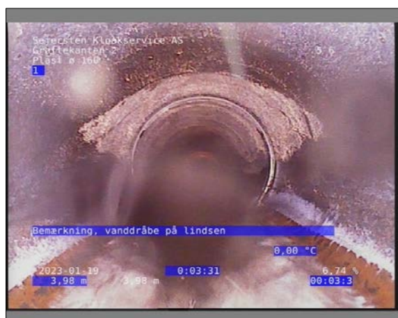
Foto: 2_1_8_19012023_150337_1.JPG 3,98m, Bemærkning / vanddråbe på lindsen
