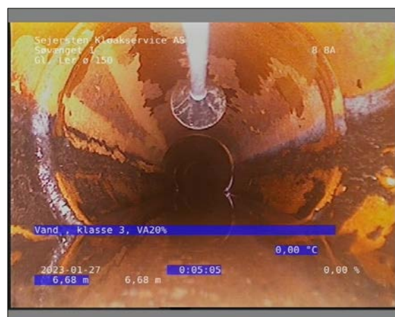
Foto: 28_1_13_27012023_103156_1.JPG 6,68m, Vand , klasse 3 / VA20%
