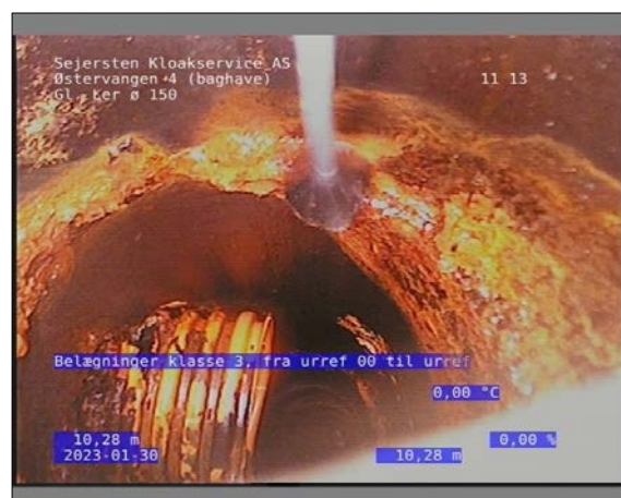
Foto: 30_1_21_30012023_131458_1.JPG 10,28m, Belægninger klasse 3, fra urref 00 til urref 12, Udfældninger, I samling
