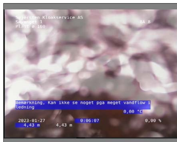
Foto: 29_1_13_27012023_113851_1.JPG 4,43m, Bemærkning / Kan ikke se noget pga meget vandflow i ledning
