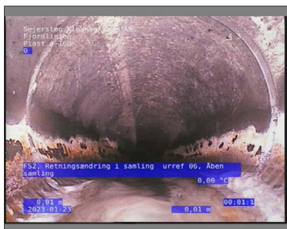
Foto: 7_1_4_23012023_112733_1.JPG 0,01m, FS2, Retningsændring i samling urref 06, Åben samling
