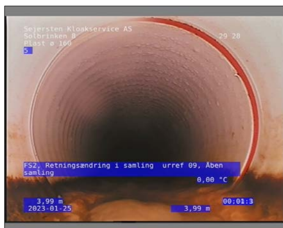
Foto: 19_1_5_25012023_110246_1.JPG 3,99m, FS2, Retningsændring i samling urref 09, Åben samling
