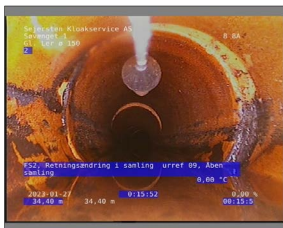
Foto: 28_1_37_27012023_104937_1.JPG 34,4m, FS2, Retningsændring i samling urref 09, Åben samling
