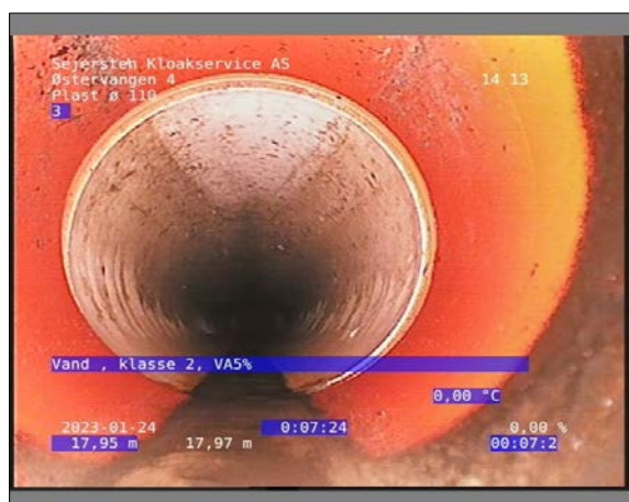
Foto: 14_1_16_24012023_114442_1.JPG 17,97m, Vand, klasse 2 / VA5%
