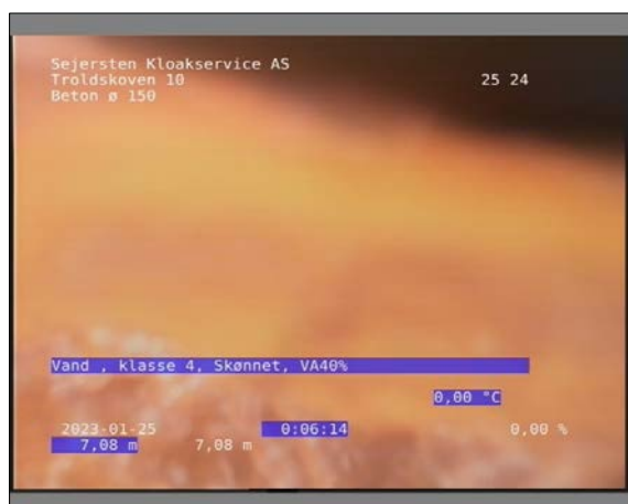
Foto: 21_1_12_25012023_133717_1.JPG 7,08m, Vand , klasse 4 / Skønnet, VA40%
