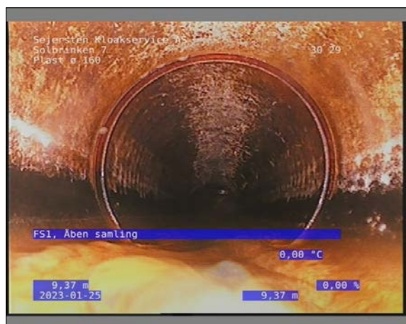
Foto: 18_1_11_25012023_104256_1.JPG 9,37m, FS1, Åben samling
