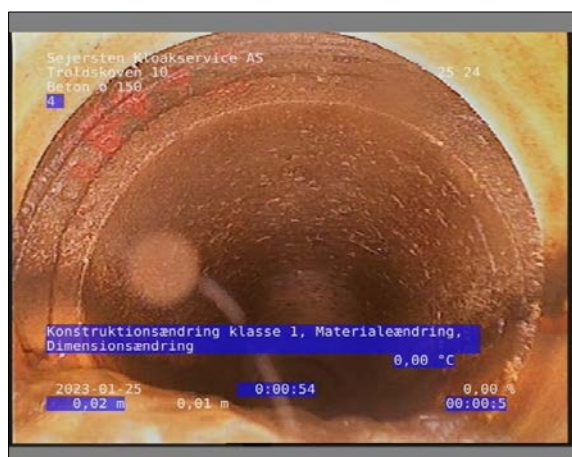
Foto: 21_1_4_25012023_132748_1.JPG 0,02m, Konstruktionsændring klasse 1, Materialeændring, Dimensionsændring
