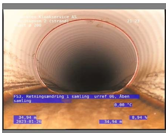
Foto: 22_1_19_26012023_082210_1.JPG 34,94m, FS3, Retningsændring i samling urref 06, Åben samling
