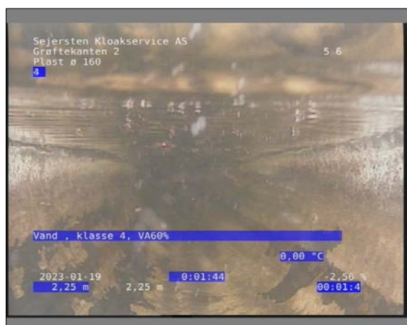
Foto: 2_1_4_19012023_150045_1.JPG 2,25m, Vand, klasse 4 / VA60%
