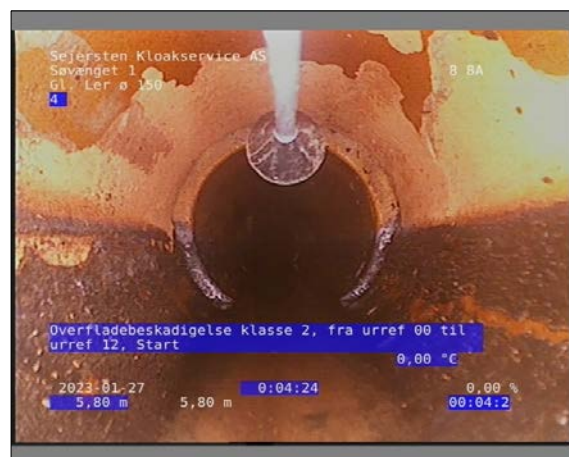
Foto: 28_1_11_27012023_103057_1.JPG 5,8m, Overfladebeskadigelse klasse 2, fra urref 00 til urref 12, Start
