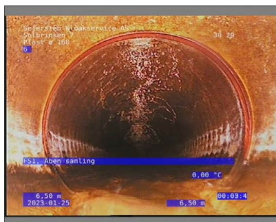
Foto: 18_1_10_25012023_104209_1.JPG 6,5m, FS1, Åben samling
