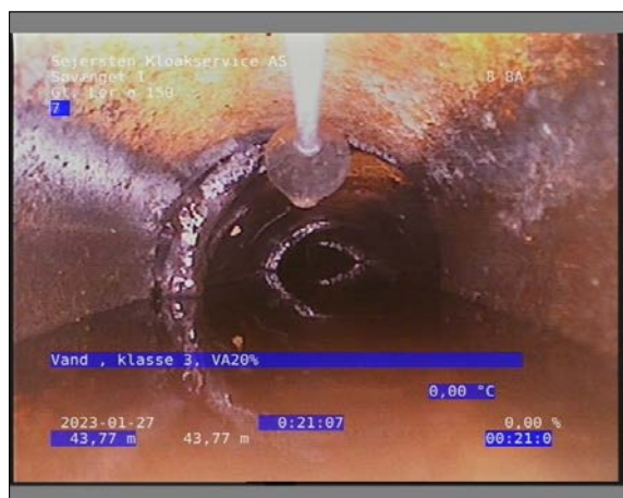
Foto: 28_1_47_27012023_105647_1.JPG 43,77m, Vand, klasse 3 / VA20%
