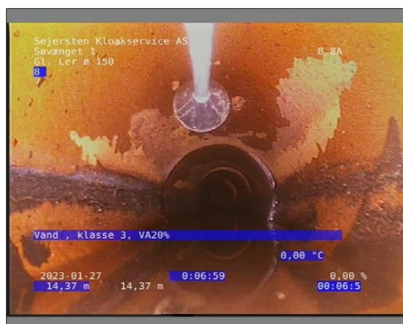
Foto: 28_1_17_27012023_103440_1.JPG 14,37m, Vand , klasse 3 / VA20%
