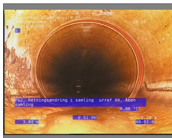
Foto: 9_1_5_23012023_140642_1.JPG 3,84m, FS2, Retningsændring i samling urref 09, Åben samling
