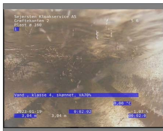
Foto: 2_1_5_19012023_150116_1.JPG 3,04m, Vand, klasse 4 / skønnet, VA70%
