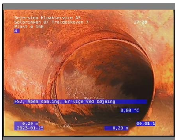
Foto: 20_1_4_25012023_123203_1.JPG 0,29m, FS2, Åben samling / Er lige ved bøjning
