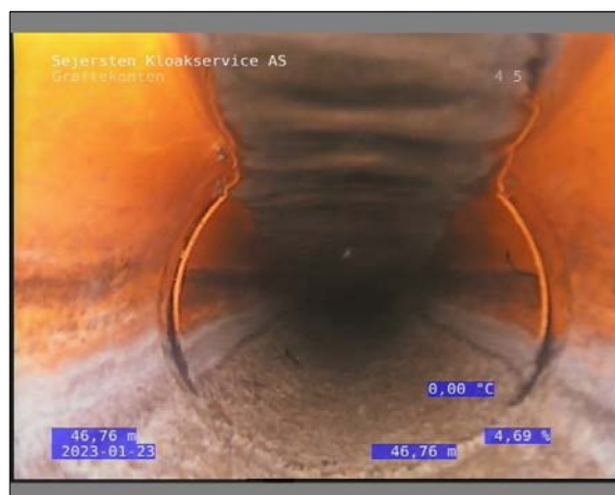
Foto: 6_1_21_23012023_104852_1.JPG 46,76m, FS3, Åben samling / kan se gummi pakning
