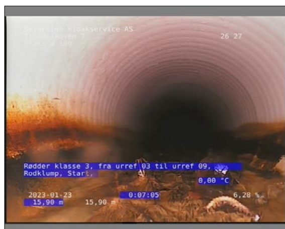
Foto: 10_1_14_23012023_145524_1.JPG 15,9m, Rødder klasse 3, fra urref 03 til urref 09, Rodklump, Start / Rødder i bunden af ledning
