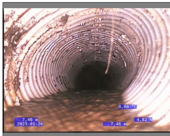
Foto: 23_1_15_26012023_094648_1.JPG 7,46m, Deformation klasse 3, fra urref 00 til urref 12, Vertikal deformation
