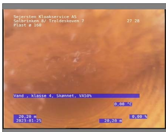
Foto: 20_1_18_25012023_124747_1.JPG 20,2m, Vand , klasse 4 / Skønnet, VA50%
