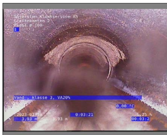
Foto: 2_1_7_19012023_150307_1.JPG 3,93m, Vand , klasse 3 / VA20%
