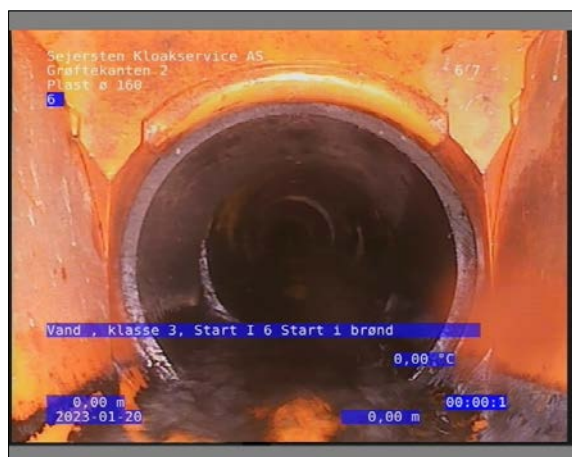
Foto: 4_1_1_20012023_101945_1.JPG 0m, Vand, klasse 3 / Start I 6 Start i brønd
