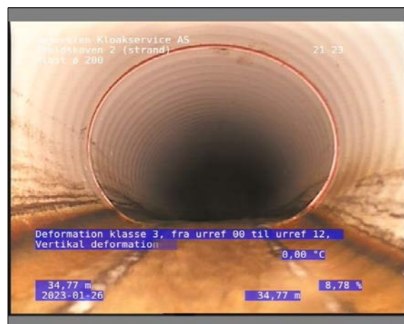
Foto: 22_1_20_26012023_082301_1.JPG 34,77m, Deformation klasse 3, fra urref 00 til urref 12, Vertikal deformation
