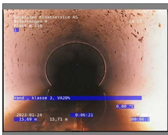
Foto: 14_1_13_24012023_114236_1.JPG 15,71m, Vand, klasse 3 / VA20%
