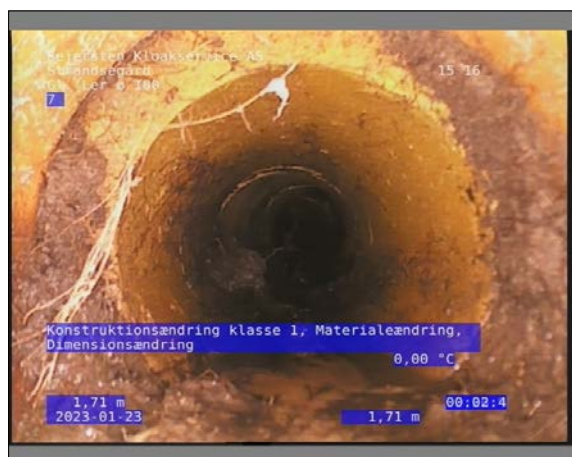
Foto: 5_1_5_23012023_084348_1.JPG 1,71m, Konstruktionsændring klasse 1, Materialeændring, Dimensionsændring
