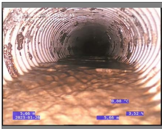
Foto: 23_1_14_26012023_094549_1.JPG 5,66m, Deformation klasse 3, fra urref 00 til urref 12, Vertikal deformation
