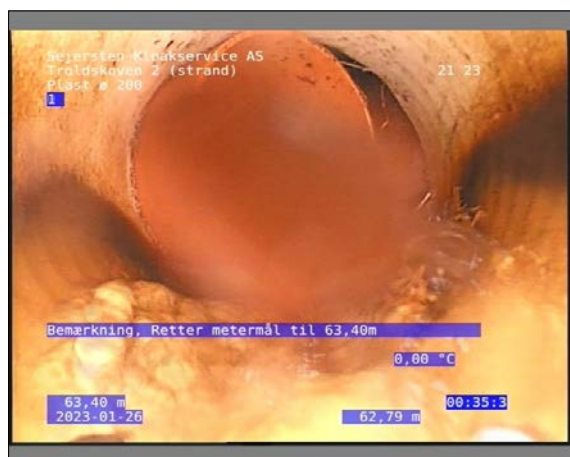
Foto: 22_1_36_26012023_090623_1.JPG 63,4m, Bemærkning / Retter metermål til 63,40m
