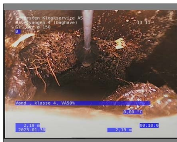
Foto: 31_1_14_30012023_141556_1.JPG 2,19m, Vand, klasse 4 / VA50%
