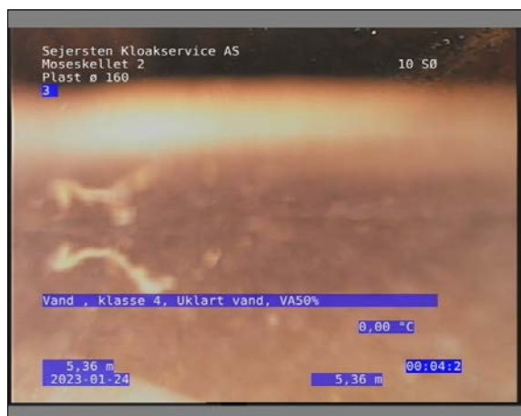
Foto: 11_1_10_24012023_080526_1.JPG 5,36m, Vand , klasse 4 / Uklart vand, VA50%
