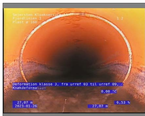
Foto: 24_1_15_26012023_102312_1.JPG 27,07m, Deformation klasse 3, fra urref 03 til urref 09, Knækdeformation
