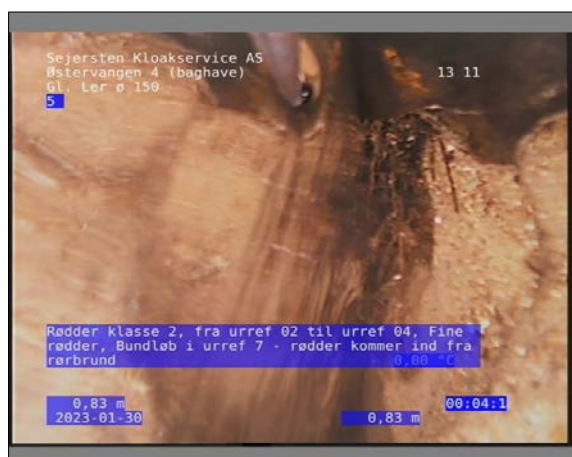
Foto: 31_1_8_30012023_140744_1.JPG 0,84m, Rødder klasse 2, fra urref 02 til urref 04, Fine rødder / Bundløb i urref 7 - rødder kommer ind fra rørbrud
