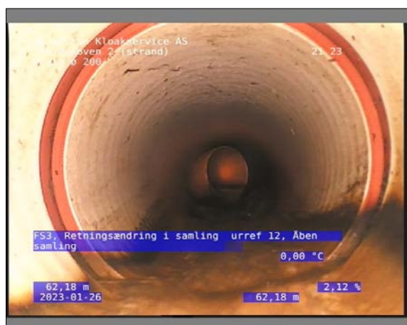
Foto: 22_1_33_26012023_083610_1.JPG 62,17m, FS3, Retningsændring i samling urref 12, Åben samling
