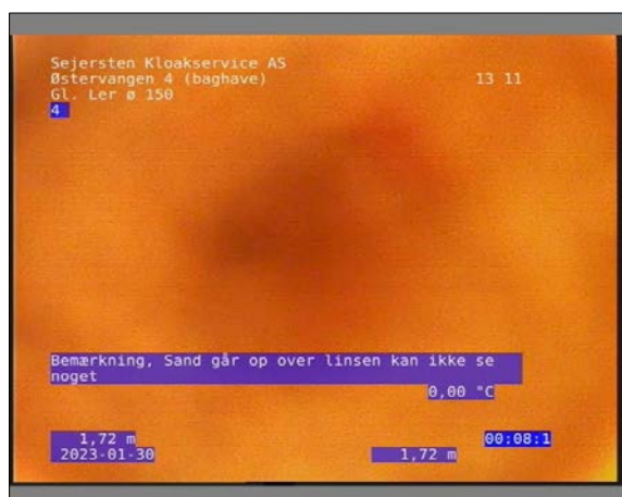
Foto: 31_1_13_30012023_141400_1.JPG 1,72m, Bemærkning / Sand går op over linsen kan ikke se noget
