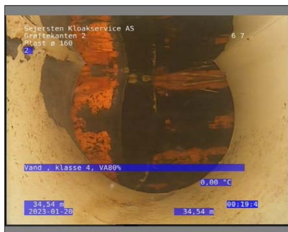
Foto: 4_1_35_20012023_104900_1.JPG 34,54m, Vand , klasse 4 / VA80%
