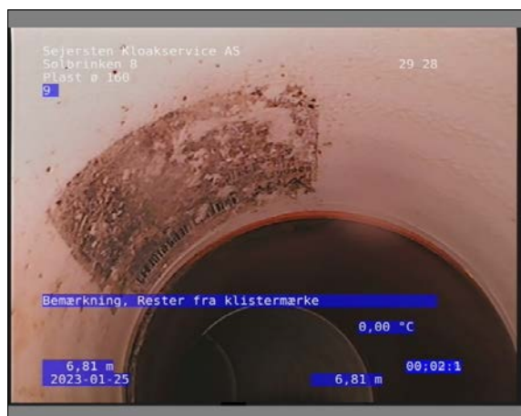
Foto: 19_1_6_25012023_110354_1.JPG 6,81m, Bemærkning / Rester fra klistermærke
