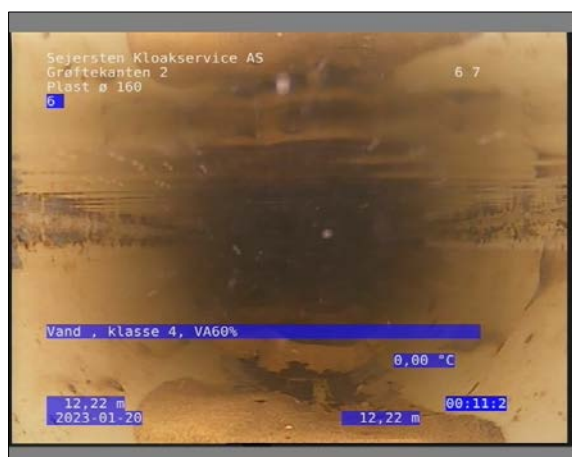
Foto: 4_1_19_20012023_103718_1.JPG 12,22m, Vand, klasse 4 / VA60%
