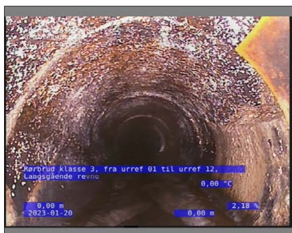
Foto: 3_1_3_20012023_093555_1.JPG 0,1m, Rørbrud klasse 3, fra urref 01 til urref 12, Langsgående revne langs røraksen
