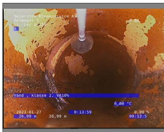
Foto: 28_1_35_27012023_104721_1.JPG 26,99m, Vand, klasse 2 / VA10%
