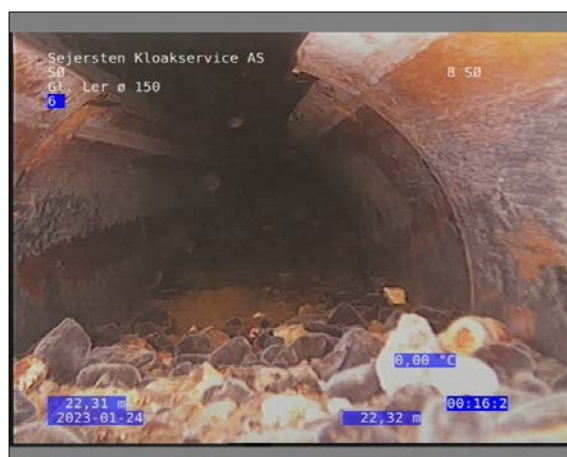
Foto: 16_1_16_24012023_142016_1.JPG 11,71m, Rødder klasse 3, fra urref 00 til urref 12, Pælerod, Stop
