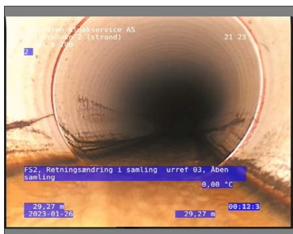
Foto: 22_1_15_26012023_081910_1.JPG 29,27m, FS2, Retningsændring i samling urref 03, Åben samling
