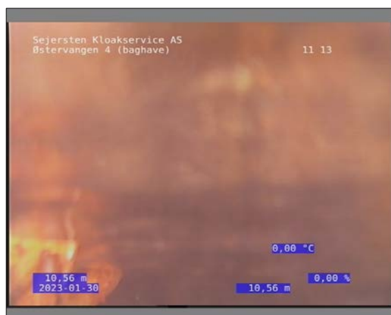
Foto: 30_1_26_30012023_131936_1.JPG 10,56m, FS3, Forskudt samling, Stop
