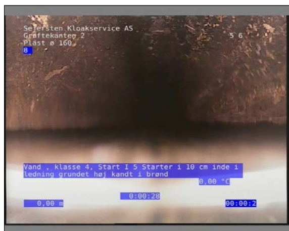
Foto: 2_1_1_19012023_145651_1.JPG Om, Vand, klasse 4 / Start I 5 Starter i 10 cm inde i ledning grundet høj kant i brønd
