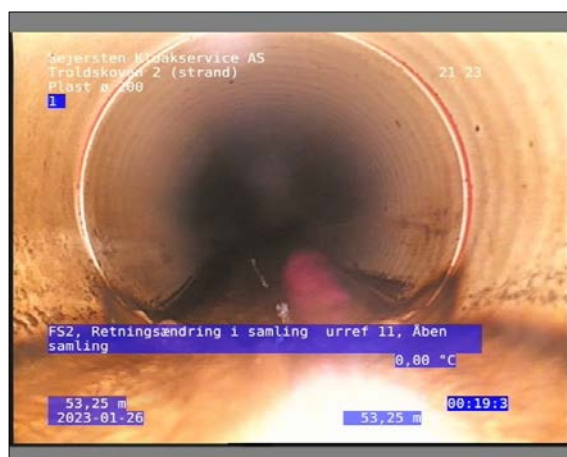
Foto: 22_1_25_26012023_082916_1.JPG 53,24m, FS2, Retningsændring i samling urref 11, Åben samling
