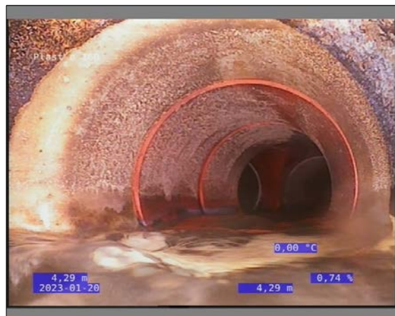
Foto: 4_1_10_20012023_102742_1.JPG 4,29m, FS3, Retningsændring i samling urref 03, Åben samling
