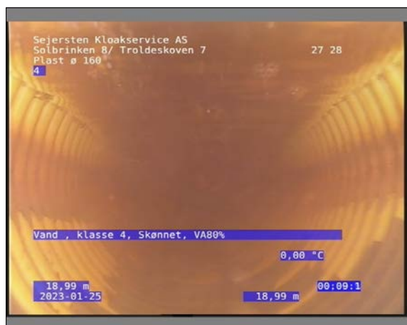
Foto: 20_1_16_25012023_124625_1.JPG 18,99m, Vand , klasse 4 / Skønnet, VA80%
