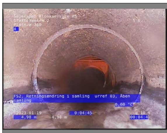
Foto: 2_1_10_19012023_150551_1.JPG 4,98m, FS2, Retningsændring i samling urref 03, Åben samling
