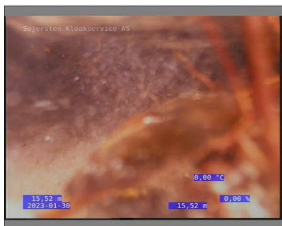
Foto: 31_1_45_30012023_144755_1.JPG 15,52m, Rødder klasse 3, fra urref 00 til urref 12, Rodklump, Start / Rødder i ledning kan ikke se hvor de kommer ind fra da der er meget flow og sand i ledning
