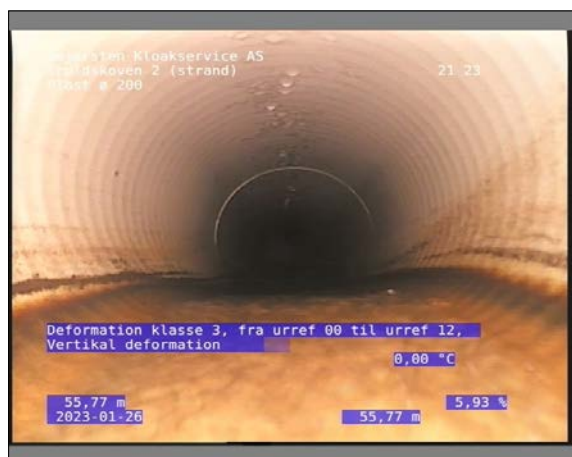
Foto: 22_1_26_26012023_083005_1.JPG 55,77m, Deformation klasse 3, fra urref 00 til urref 12, Vertikal deformation
