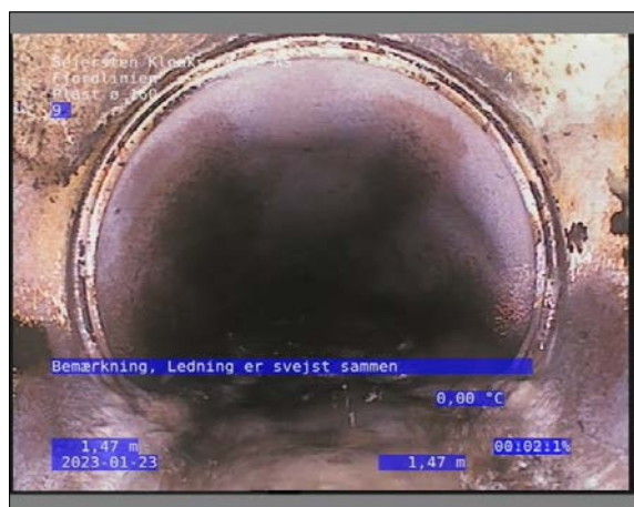
Foto: 7_1_6_23012023_113520_1.JPG 1,47m, Bemærkning / Ledning er svejst sammen
