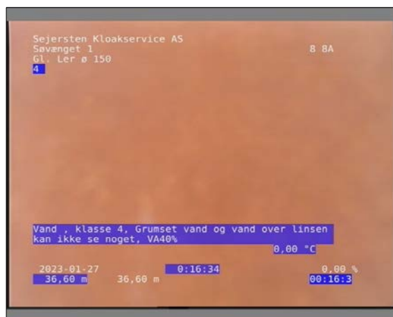
Foto: 28_1_39_27012023_105058_1.JPG 36,6m, Vand, klasse 4 / Grumset vand og vand over linsen kan ikke se noget, VA40%
