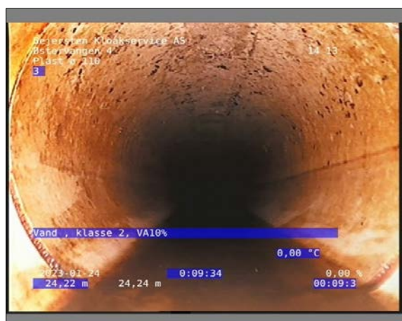
Foto: 14_1_20_24012023_114738_1.JPG 24,24m, Vand , klasse 2 / VA10%
