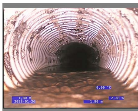
Foto: 23_1_9_26012023_094312_1.JPG 1,8m, Deformation klasse 3, fra urref 00 til urref 12, Vertikal deformation
