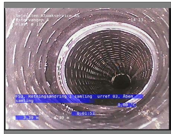
Foto: 14_1_4_24012023_113216_1.JPG 3,39m, FS3, Retningsændring i samling urref 03, Åben samling
