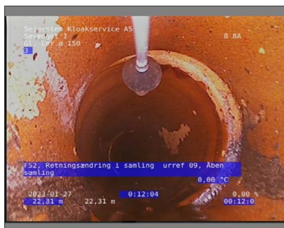
Foto: 28_1_29_27012023_104349_1.JPG 22,31m, FS2, Retningsændring i samling urref 09, Åben samling
