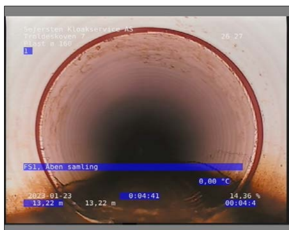
Foto: 10_1_8_23012023_144917_1.JPG 13,22m, FS1, Åben samling
