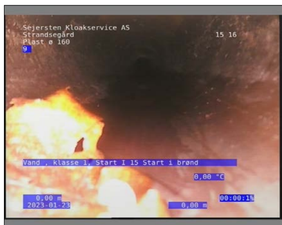
Foto: 5_1_1_23012023_083915_1.JPG 0m, Vand , klasse 1 / Start I 15 Start i brønd
