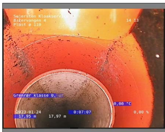
Foto: 14_1_15_24012023_114418_1.JPG 17,97m, Grenrør klasse 0, urref 12 / Grenrør kommer i urref 12 på ledningen
