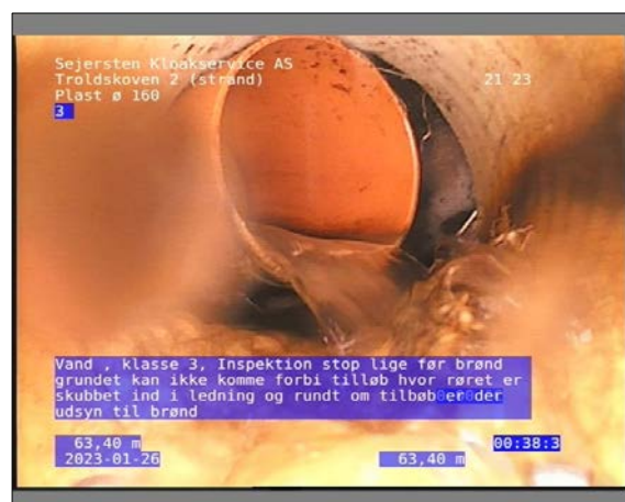
Foto: 22_1_40_26012023_091444_1.JPG 63,4m, Vand , klasse 3, Inspektion stop lige før brønd grundet kan ikke komme forbi tilbøb hvor røret er skubbet ind i ledning og rundt om tilbøb er der udsyn til brønd
