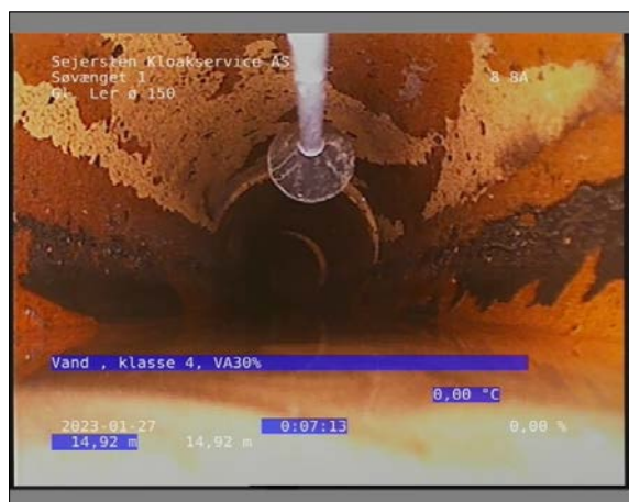
Foto: 28_1_18_27012023_103502_1.JPG 14,92m, Vand , klasse 4 / VA30%
