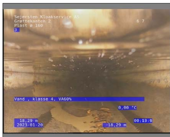
Foto: 4_1_22_20012023_104013_1.JPG 18,29m, Vand , klasse 4 / VA60%
