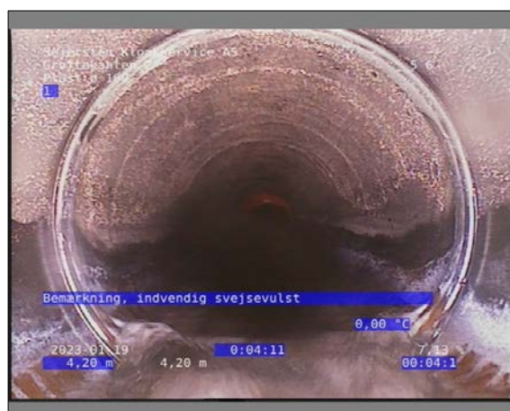
Foto: 2_1_9_19012023_150500_1.JPG 4,2m, Bemærkning / indvendig svejseulst
