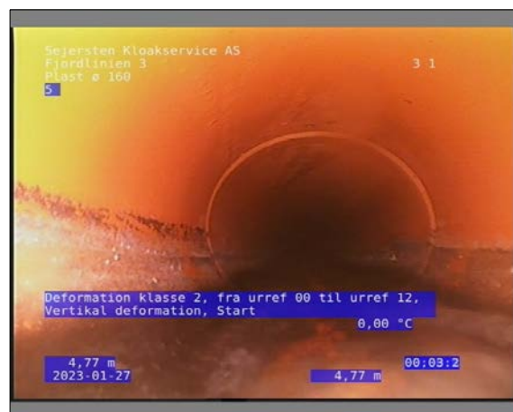
Foto: 25_1_8_27012023_084717_1.JPG 4,77m, Deformation klasse 2, fra urref 00 til urref 12, Vertikal deformation, Start
