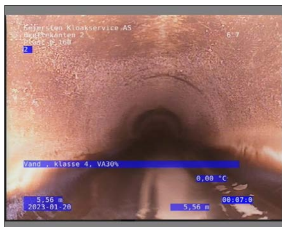
Foto: 4_1_14_20012023_103143_1.JPG 5,56m, Vand , klasse 4 / VA30%
