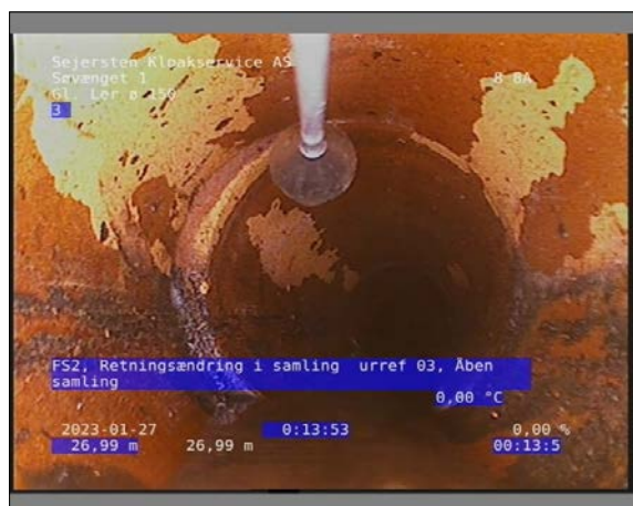
Foto: 28_1_34_27012023_104708_1.JPG 26,99m, FS2, Retningsændring i samling urref 03, Åben samling
