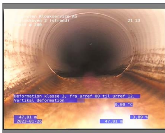
Foto: 22_1_23_26012023_082650_1.JPG 47,01m, Deformation klasse 3, fra urref 00 til urref 12, Vertikal deformation
