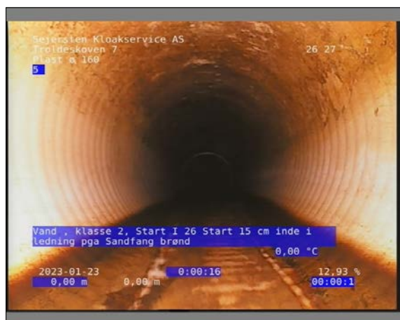
Foto: 10_1_1_23012023_144255_1.JPG 0m, Vand, klasse 2 / Start I 26 Start 15 cm inde i ledning pga Sandfang brønd
