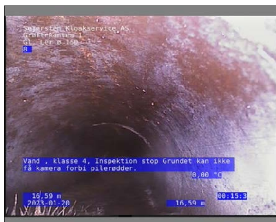
Foto: 3_1_29_20012023_095933_1.JPG 16,59m, Vand , klasse 4 / Inspektion stop Grundet kan ikke få kamera forbi pilerødder.
