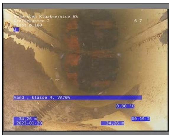
Foto: 4_1_34_20012023_104832_1.JPG 34,26m, Vand , klasse 4 / VA70%
