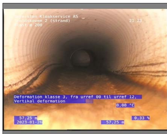
Foto: 22_1_27_26012023_083108_1.JPG 57,25m, Deformation klasse 3, fra urref 00 til urref 12, Vertikal deformation
