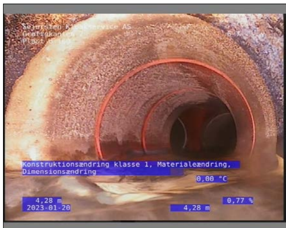
Foto: 4_1_9_20012023_102653_1.JPG 4,28m, Konstruktionsændring klasse 1, Materialeændring, Dimensionsændring
