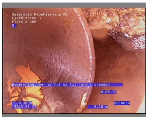
Foto: 25_1_2_27012023_084241_1.JPG 0,1m, Bemærkning / Der er hul ud til jord i brønden
