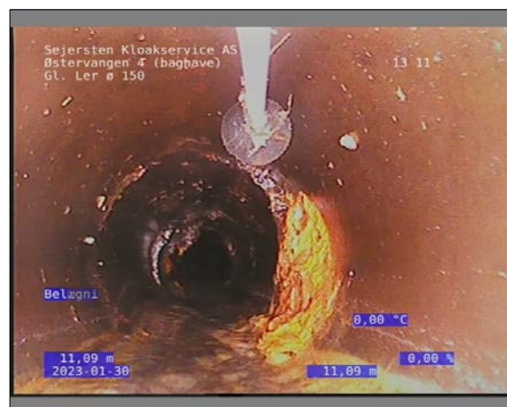
Foto: 31_1_31_30012023_143202_1.JPG 11,09m, Belægninger klasse 3, fra urref 01 til urref 05, Udfældninger, I samling
