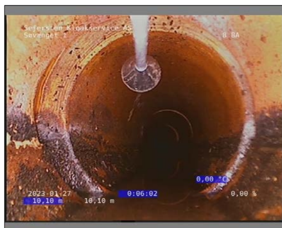
Foto: 28_1_15_27012023_103316_1.JPG 10,1m, FS3, Retningsændring i samling urref 03, Åben samling
