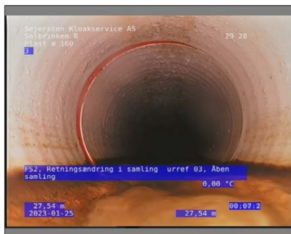
Foto: 19_1_11_25012023_111122_1.JPG 27,54m, FS2, Retningsændring i samling urref 03, Åben samling
