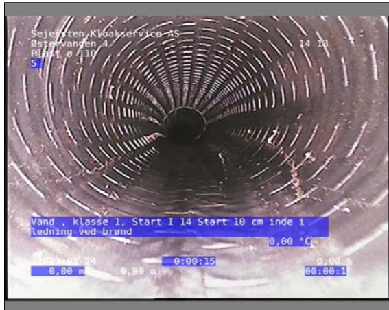
Foto: 14_1_1_24012023_112841_1.JPG 0m, Vand, klasse 1 / Start I 14 Start 10 cm inde i ledning ved brønd - Fejl i startskærm tekst løber ikke til brønd 13 men til stiktilslutning 13A
