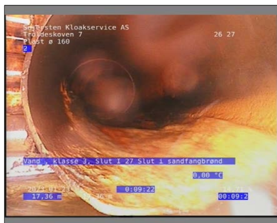
Foto: 10_1_17_23012023_145850_1.JPG 17,36m, Vand , klasse 3 / Slut I 27 Slut i sandfangbrønd
