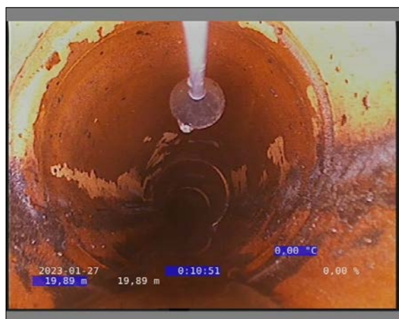
Foto: 28_1_26_27012023_104129_1.JPG 19,89m, Rørbrud klasse 4, fra urref 00 til urref 12, Sammensatte revner, Stop
