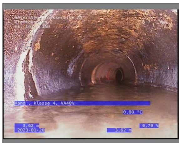
Foto: 4_1_7_20012023_102443_1.JPG 3,62m, Vand , klasse 4 / VA40%
