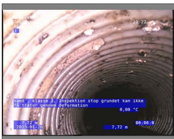
Foto: 23_1_18_26012023_094750_1.JPG 7,72m, Vand , klasse 3 / Inspektion stop grundet kan ikke få trator gennem deformation
