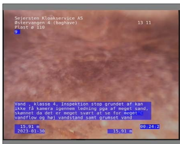
Foto: 31_1_51_30012023_145723_1.JPG 15,92m, Vand , klasse 4 / Inspektion stop grundet af kan ikke få kamera igennem ledning pga af meget sand, skønnet da det er meget svært at se for meget vandflow og høj vandstand samt grumset vand
