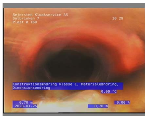
Foto: 18_1_5_25012023_103847_1.JPG 0,7m, Konstruktionsændring klasse 1, Materialeændring, Dimensionsændring
