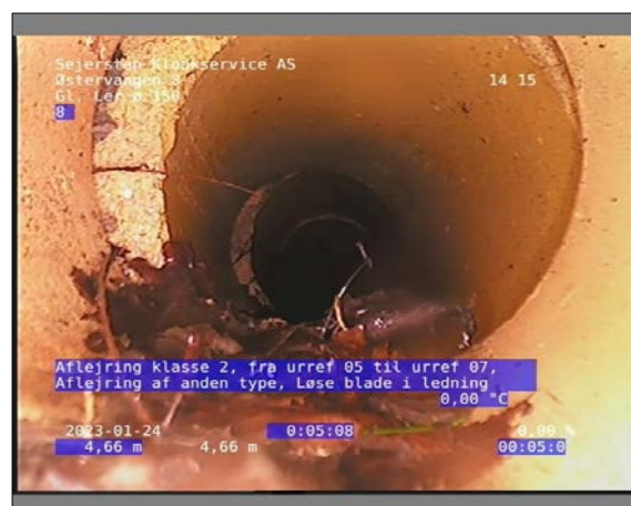
Foto: 13_1_14_24012023_100235_1.JPG 4,66m, Aflejring klasse 2, fra urref 05 til urref 07, Aflejring af anden type / Løse blade i ledning
