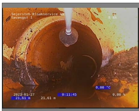
Foto: 28_1_28_27012023_104314_1.JPG 21,61m, FS3, Retningsændring i samling urref 03, Forskudt samling
