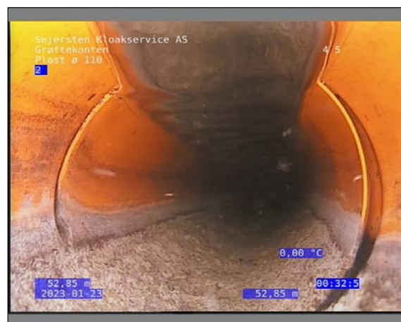
Foto: 6_1_25_23012023_105925_1.JPG 52,85m, FS3, Retningsændring i samling urref 03, Åben samling
