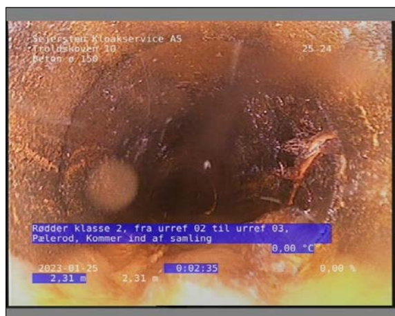
Foto: 21_1_6_25012023_133102_1.JPG 2,31m, Rødder klasse 2, fra urref 02 til urref 03, Pælerod / Kommer ind af samling
