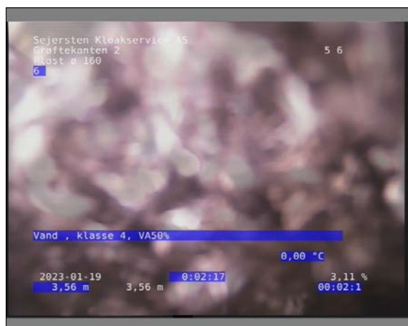
Foto: 2_1_6_19012023_150145_1.JPG 3,56m, Vand , klasse 4 / VA50%
