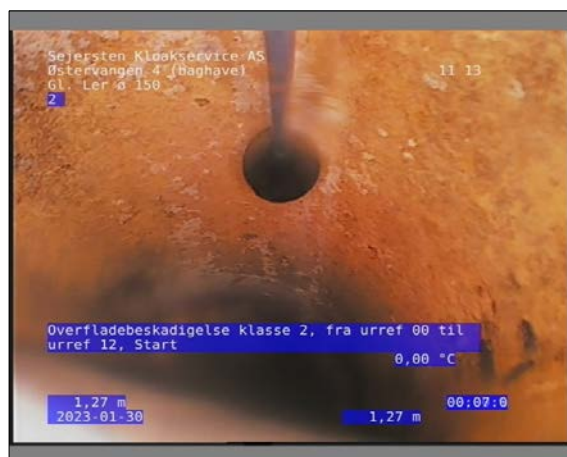
Foto: 30_1_7_30012023_125607_1.JPG 1,27m, Overfladebeskadigelse klasse 2, fra urref 00 til urref 12, Start
