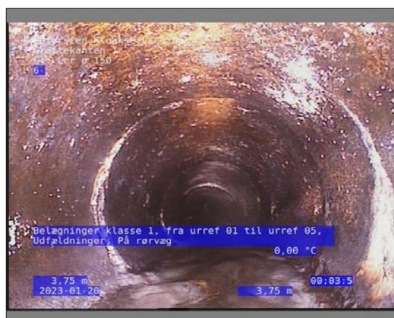
Foto: 3_1_8_20012023_094022_1.JPG 3,75m, Belægninger klasse 1, fra urref 01 til urref 05, Udfældninger, På rørveg
