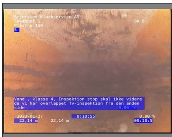
Foto: 29_1_20_27012023_114642_1.JPG 22,14m, Vand , klasse 4 / Inspektion stop skal ikke videre da vi har overlappet Tv-inspektion fra den anden side
