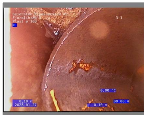
Foto: 25_1_2_27012023_084253_2.JPG 0,1m, Bemærkning / Der er hul ud til jord i brønden
