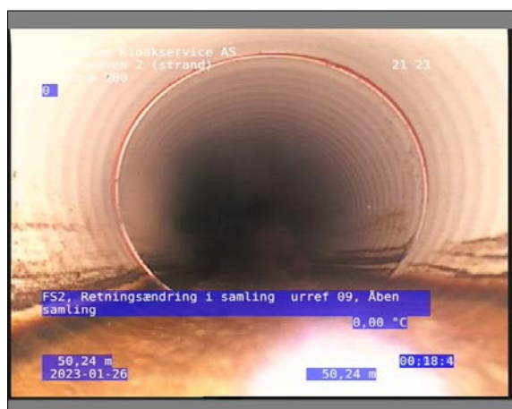
Foto: 22_1_24_26012023_082801_1.JPG 50,24m, FS2, Retningsændring i samling urref 09, Åben samling
