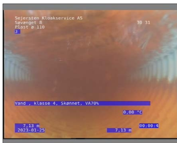
Foto: 17_1_12_25012023_090720_1.JPG 7,13m, Vand , klasse 4 / Skønnet, VA70%
