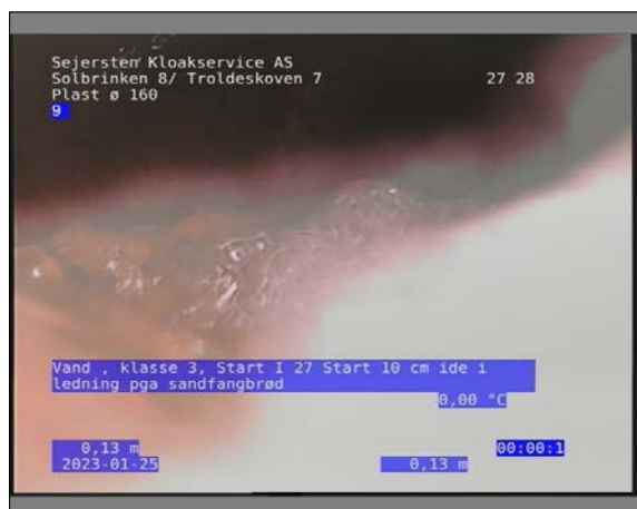
Foto: 20_1_1_25012023_122848_1.JPG 0,13m, Vand , klasse 3 / Start I 27 Start 10 cm ide i ledning pga sandfangbrød
