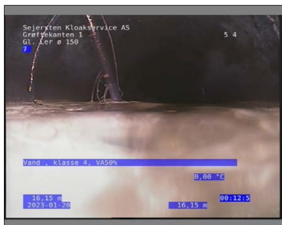
Foto: 3_1_24_20012023_095454_1.JPG 16,15m, Vand , klasse 4 / VA50%
