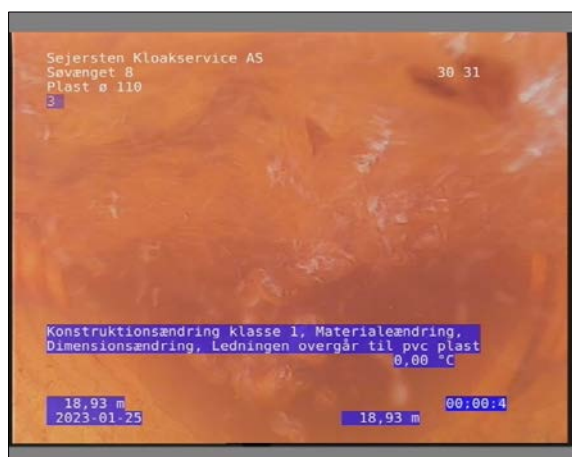
Foto: 17_1_15_25012023_091322_1.JPG 18,93m, Konstruktionsændring klasse 1, Materialeændring, Dimensionsændring / Ledningen overgår til pvc plast
