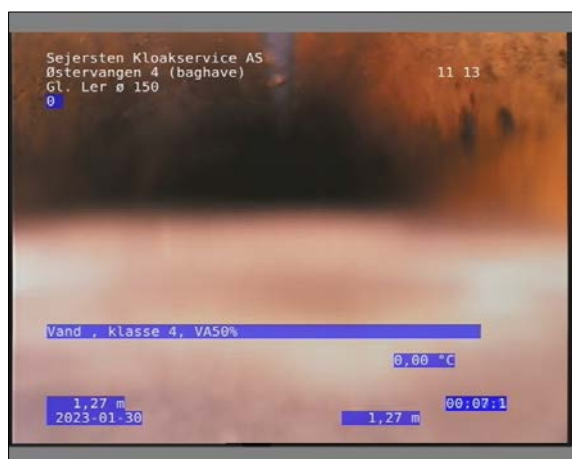
Foto: 30_1_8_30012023_125620_1.JPG 1,27m, Vand, klasse 4 / VA50%
