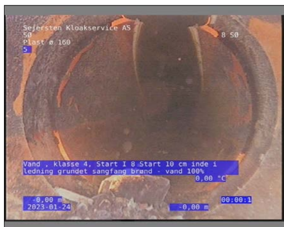
Foto: 16_1_1_24012023_134655_1.JPG 0m, Vand, klasse 4 / Start I 8 Start 10 cm inde i ledning grundet sangfang brønd - vand 100%
