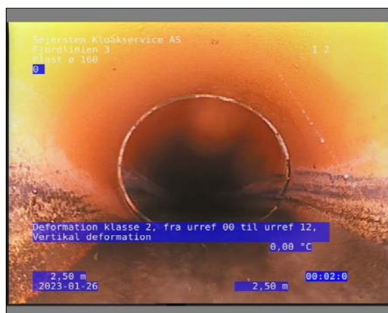
Foto: 24_1_5_26012023_101107_1.JPG 2,5m, Deformation klasse 2, fra urref 00 til urref 12, Vertikal deformation
