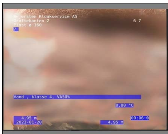
Foto: 4_1_13_20012023_103035_1.JPG 4,95m, Vand , klasse 4 / VA50%
