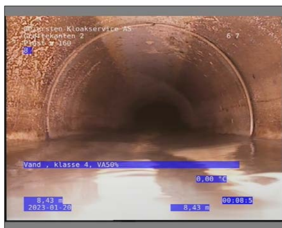
Foto: 4_1_16_20012023_103355_1.JPG 8,43m, Vand , klasse 4 / VA50%
