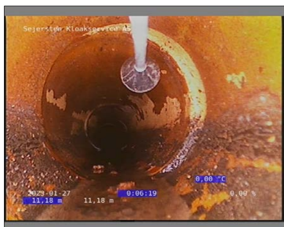
Foto: 28_1_16_27012023_103352_1.JPG 11,18m, FS3, Retningsændring i samling urref 09, Åben samling
