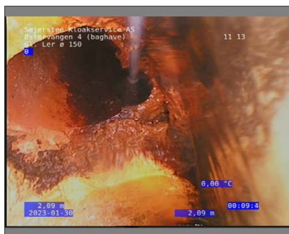
Foto: 30_1_12_30012023_130211_2.JPG 2,07m, Påhugget stik klasse 1, urref 03, Manglende forbindelse mellem stik/hovedledning / Kan kun skimte påhungen pga af meget vand i ledning
