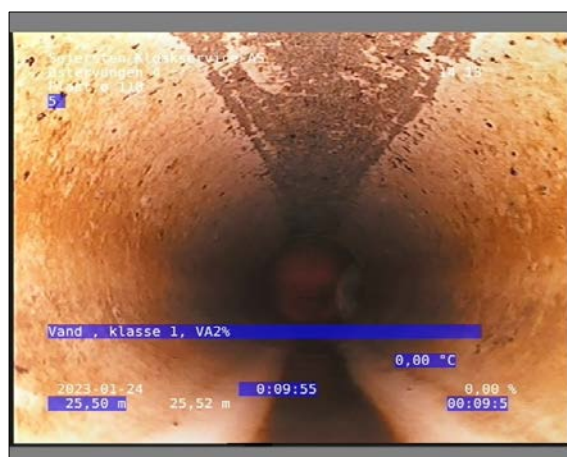
Foto: 14_1_21_24012023_114809_1.JPG 25,52m, Vand , klasse 1 / VA2%
