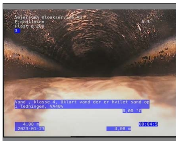
Foto: 7_1_11_23012023_114017_1.JPG 4,08m, Vand, klasse 4 / Uklart vand der er hvilet sand op i ledningen, VA40%
