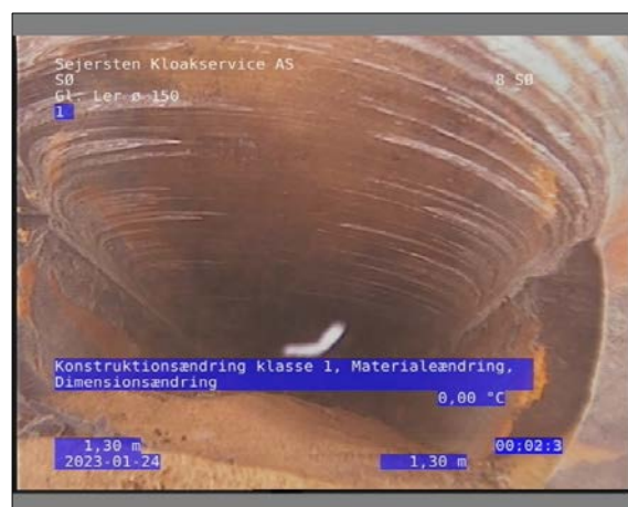
Foto: 16_1_7_24012023_135200_1.JPG 1,3m, Konstruktionsændring klasse 1, Materialeændring, Dimensionsændring
