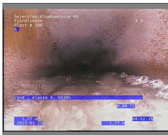
Foto: 7_1_7_23012023_113548_1.JPG 1,77m, Vand , klasse 4 / VA30%
