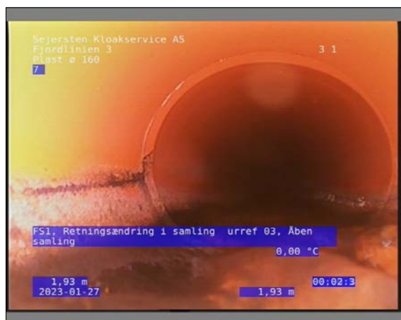
Foto: 25_1_7_27012023_084617_1.JPG 1,93m, FS1, Retningsændring i samling urref 03, Åben samling
