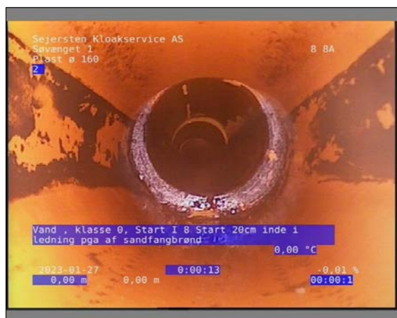
Foto: 27_1_1_27012023_100758_1.JPG 0m, Vand, klasse 0 / Start I 8 Start 20cm inde i ledning pga af sandfangbrønd
