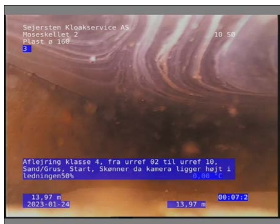
Foto: 11_1_14_24012023_081116_1.JPG 13,97m, Aflejring klasse 4, fra urref 02 til urref 10, Sand/Grus, Start / Skønner da kamera ligger højt i ledningen 50%
