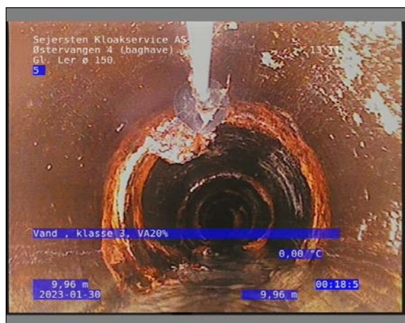
Foto: 31_1_30_30012023_143046_1.JPG 9,96m, Vand , klasse 3 / VA20%
