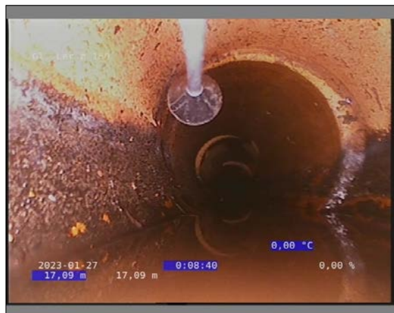
Foto: 28_1_22_27012023_103717_1.JPG 17,09m, FS3, Åben samling
