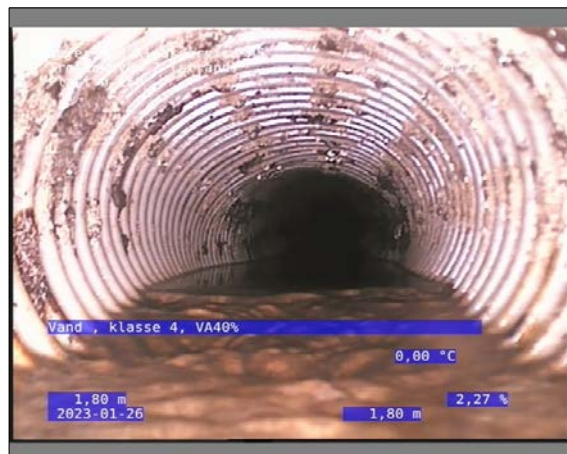
Foto: 23_1_11_26012023_094354_1.JPG 1,8m, Vand , klasse 4 / VA40%
