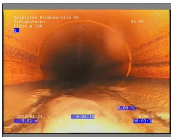
Foto: 8_1_7_23012023_132113_2.JPG 1,77m, Deformation klasse 2, fra urref 00 til urref 12, Vertikal deformation, Start
