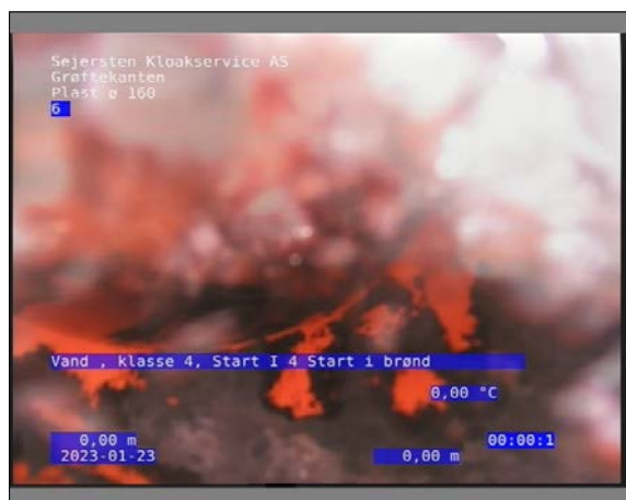
Foto: 6_1_1_23012023_101805_1.JPG 0m, Vand, klasse 4 / Start I 4 Start i brønd
