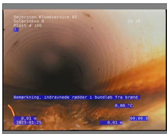
Foto: 19_1_4_25012023_110126_1.JPG 0,01m, Bemærkning / indravnede rødder i bundløb fra brønd
