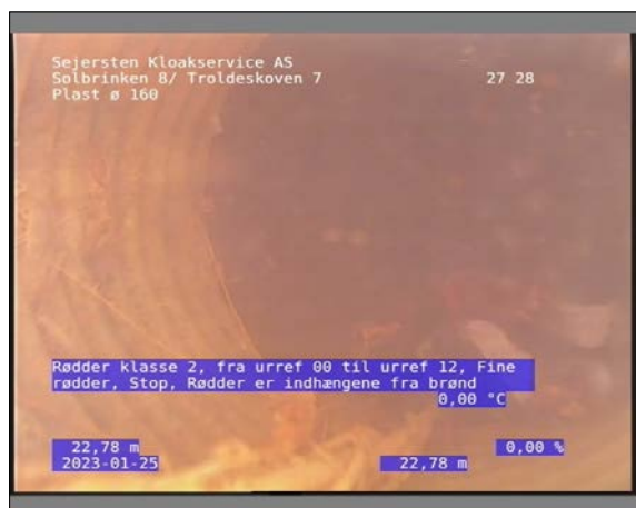
Foto: 20_1_20_25012023_124934_1.JPG 22,78m, Rødder klasse 2, fra urref 00 til urref 12, Fine rødder, Stop / Rødder er indhængene fra brønd
