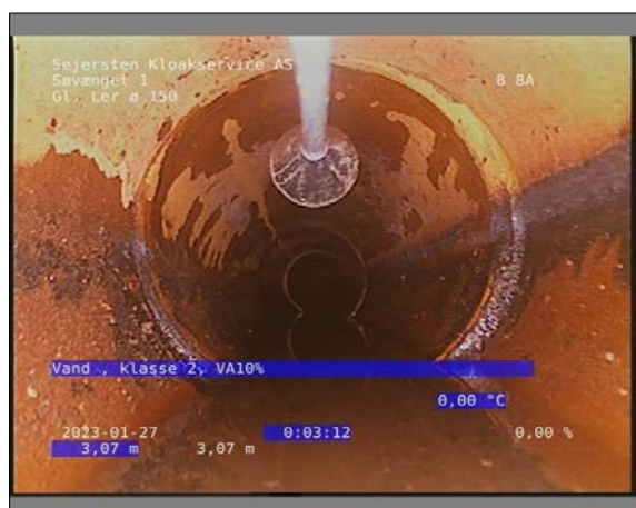
Foto: 28_1_8_27012023_102836_1.JPG 3,07m, Vand, klasse 2 / VA10%
