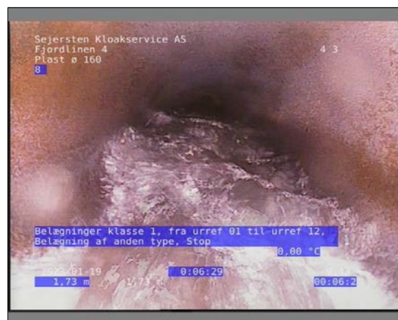
Foto: 1_1_6_19012023_142830_1.JPG 1,73m, Belægninger klasse 1, fra urref 01 til urref 12, Belægning af anden type, Stop
