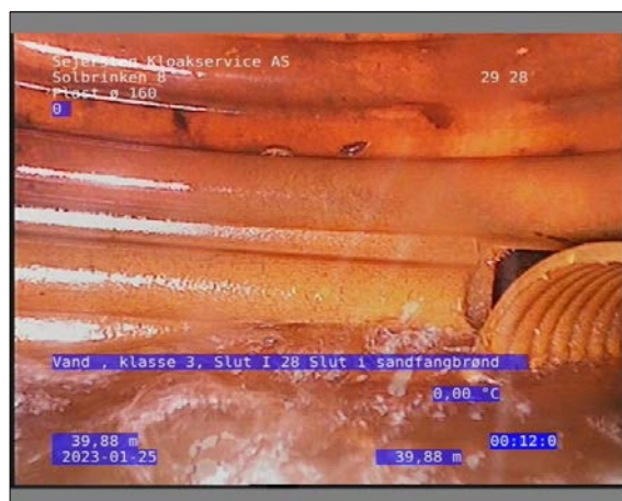
Foto: 19_1_16_25012023_112145_1.JPG 39,88m, Vand, klasse 3 / Slut I 28 Slut i sandfangbrønd
