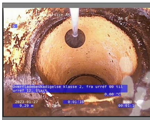
Foto: 29_1_4_27012023_113039_1.JPG 0,29m, Overfladebeskadigelse klasse 2, fra urref 00 til urref 12, Start
