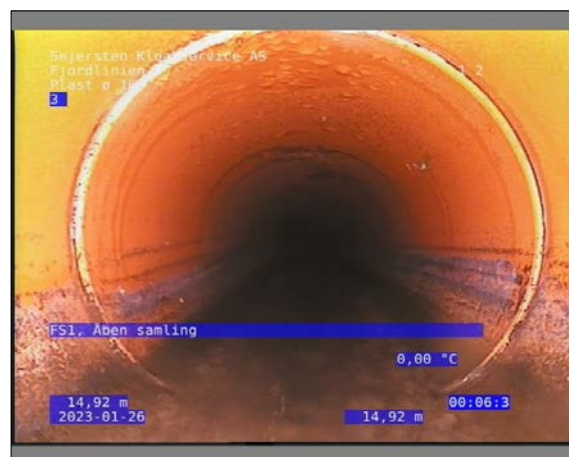
Foto: 24_1_13_26012023_102013_1.JPG 14,92m, FS1, Åben samling
