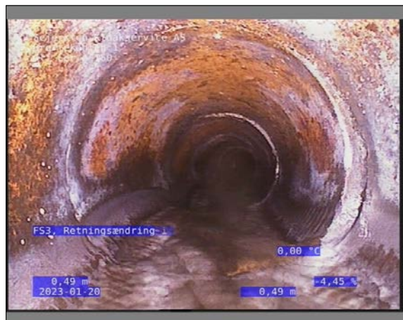
Foto: 3_1_5_20012023_093755_1.JPG 0,49m, FS3, Retningsændring i samling urref 03, Åben samling
