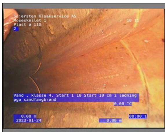
Foto: 12_1_1_24012023_082837_1.JPG 0m, Vand, klasse 4 / Start I 10 Start 10 cm i ledning pga sandfangbrønd
