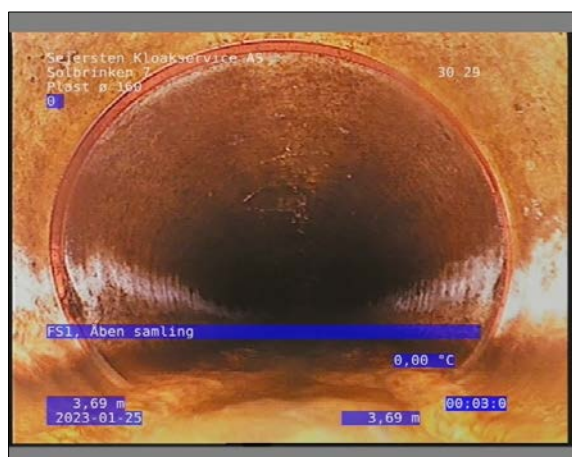
Foto: 18_1_9_25012023_104115_1.JPG 3,69m, FS1, Åben samling
