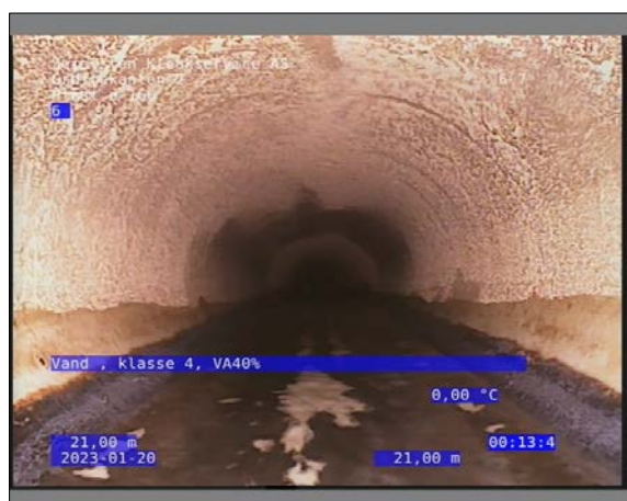
Foto: 4_1_23_20012023_104102_1.JPG 21m, Vand , klasse 4 / VA40%
