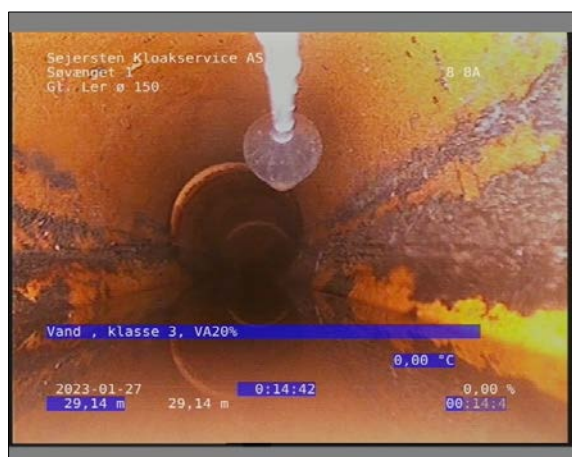
Foto: 28_1_36_27012023_104811_1.JPG 29,14m, Vand, klasse 3 / VA20%
