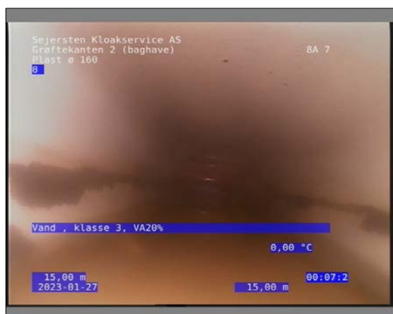
Foto: 26_1_14_27012023_093403_1.JPG 15m, Vand, klasse 3 / VA20%
