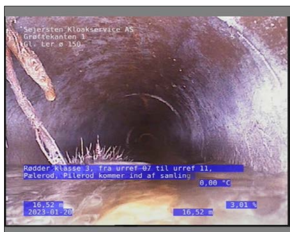
Foto: 3_1_26_20012023_095704_1.JPG 16,52m, Rødder klasse 3, fra urref 07 til urref 11, Pælerod / Pilerod kommer ind af samling
