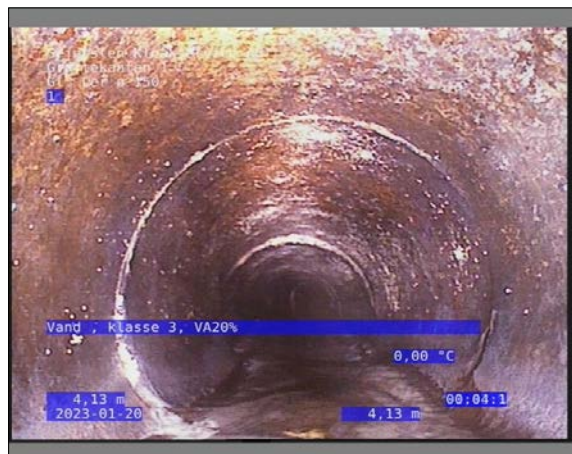
Foto: 3_1_9_20012023_094044_1.JPG 4,13m, Vand , klasse 3 / VA20%
