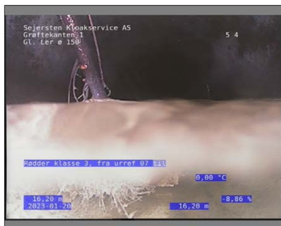
Foto: 3_1_25_20012023_095556_1.JPG 16,2m, Rødder klasse 3, fra urref 07 til urref 11, Pælerod / Pilerod kommer ind af samling
