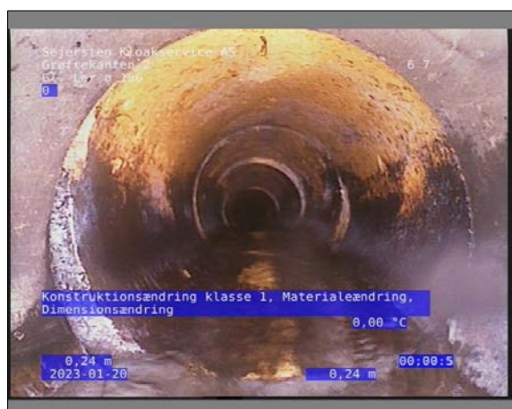
Foto: 4_1_3_20012023_102103_1.JPG 0,24m, Konstruktionsændring klasse 1, Materialeændring, Dimensionsændring
