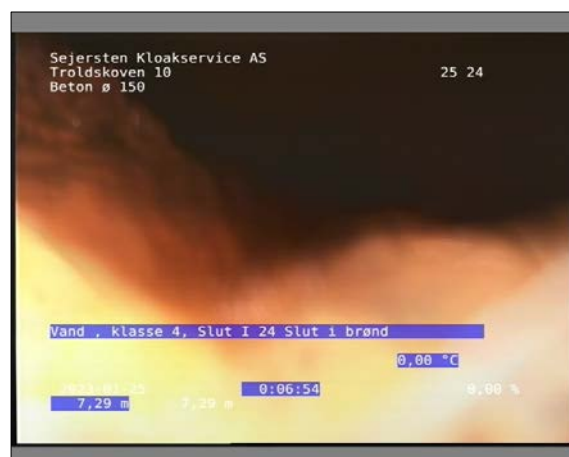
Foto: 21_1_15_25012023_133824_1.JPG 7,29m, Vand , klasse 4 / Slut I 24 Slut i brønd - Ledningen ender i brønd som ikke er afmærket på tegning men slutter i brønd 25A
