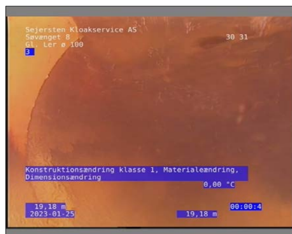
Foto: 17_1_16_25012023_091512_1.JPG 19,18m, Konstruktionsændring klasse 1, Materialeændring, Dimensionsændring
