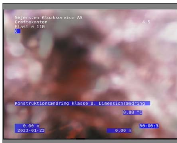
Foto: 6_1_3_23012023_102003_1.JPG 0,01m, Konstruktionsændring klasse 0, Dimensionsændring
