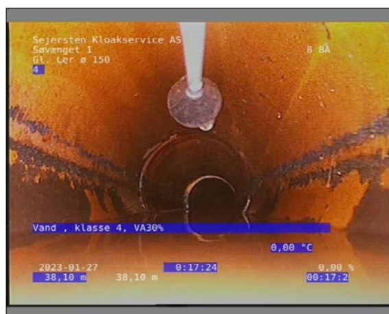
Foto: 28_1_41_27012023_105159_1.JPG 38,1m, Vand, klasse 4 / VA30%
