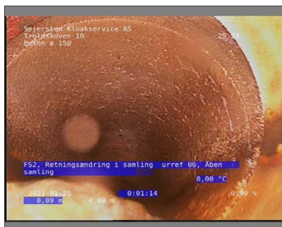
Foto: 21_1_5_25012023_132827_1.JPG 0,09m, FS2, Retningsændring i samling urref 06, Åben samling
