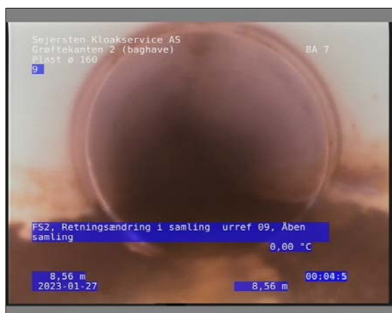
Foto: 26_1_9_27012023_093031_1.JPG 8,56m, FS2, Retningsændring i samling urref 09, Åben samling
