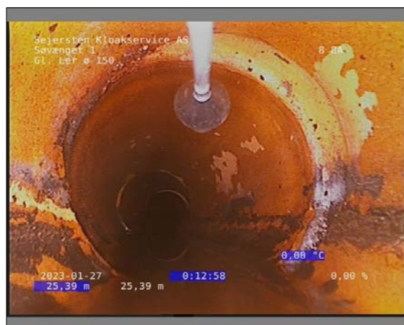
Foto: 28_1_31_27012023_104513_1.JPG 25,39m, FS3, Retningsændring i samling urref 03, Åben samling
