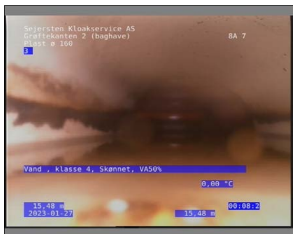
Foto: 26_1_17_27012023_093615_1.JPG 15,48m, Vand, klasse 4 / Skønnet, VA50%
