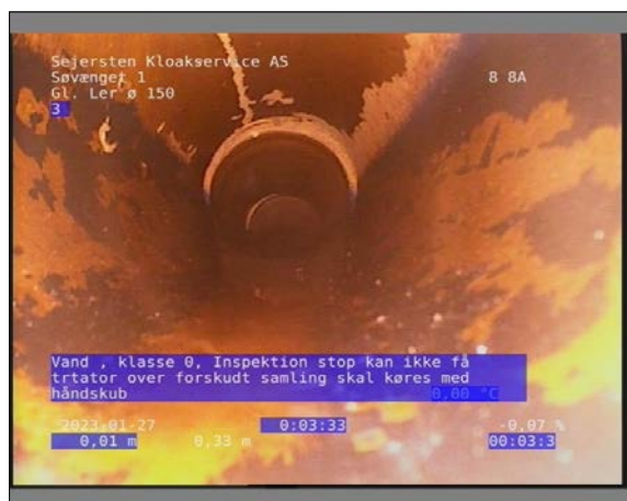
Foto: 27_1_9_27012023_101526_1.JPG 0,33m, Vand , klasse 0 / Inspektion stop kan ikke få trtator over forskudt samling skal køres med håndskub
