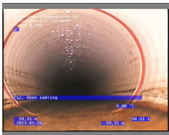
Foto: 22_1_30_26012023_083346_1.JPG 59,31m, FS2, Åben samling
