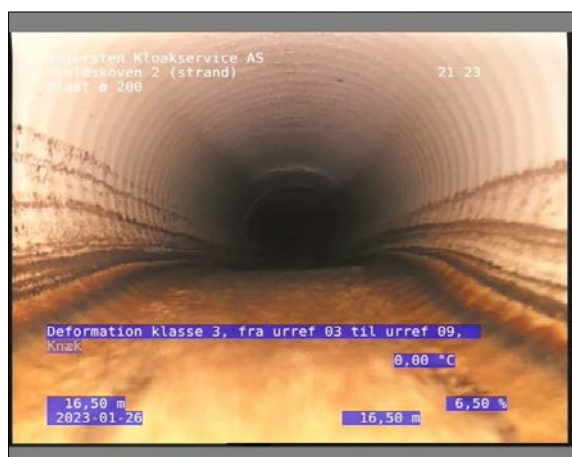
Foto: 22_1_10_26012023_081401_1.JPG 16,5m, Deformation klasse 3, fra urref 03 til urref 09, Knækdeformation
