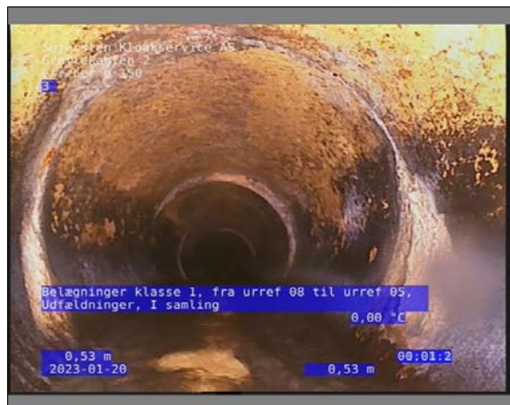
Foto: 4_1_5_20012023_102233_1.JPG 0,53m, Belægninger klasse 1, fra urref 08 til urref 05, Udfældninger, I samling
