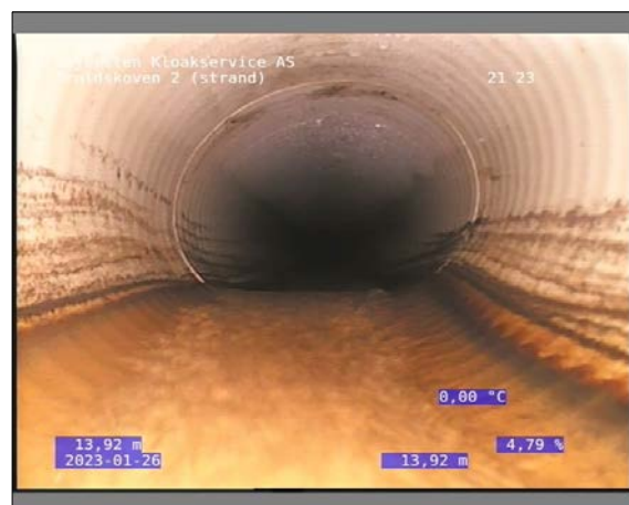
Foto: 22_1_9_26012023_081246_1.JPG 13,92m, Deformation klasse 3, fra urref 00 til urref 12, Vertikal deformation
