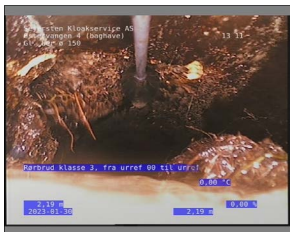
Foto: 31_1_15_30012023_141639_1.JPG 2,19m, Rørbrud klasse 3, fra urref 00 til urref 12, Sammensatte revner / meget sand og vand i ledning - Skønnet
