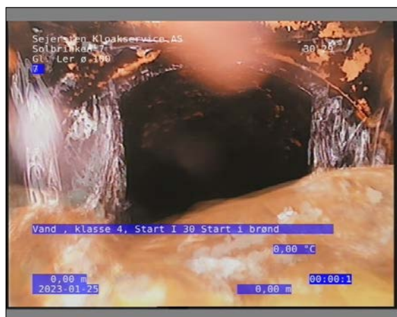
Foto: 18_1_1_25012023_103547_1.JPG 0m, Vand, klasse 4 / Start I 30 Start i brønd
