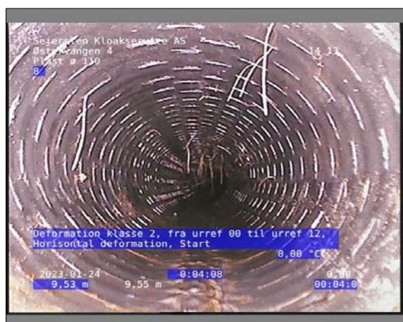
Foto: 14_1_8_24012023_113846_1.JPG 9,55m, Deformation klasse 2, fra urref 00 til urref 12, Horizontal deformation, Start
