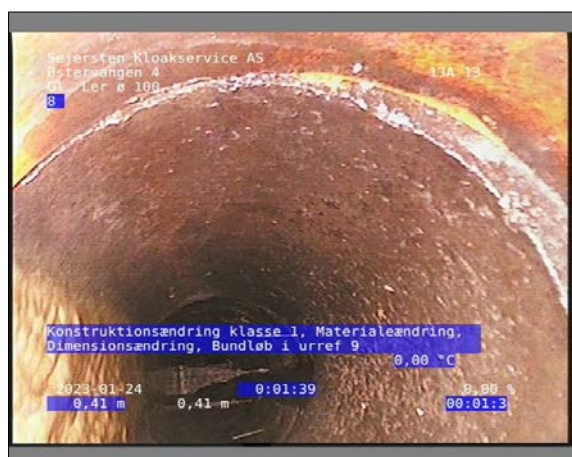
Foto: 15_1_4_24012023_120828_1.JPG 0,41m, Konstruktionsændring klasse 1, Materialeændring, Dimensionsændring / Bundløb i urref 9
