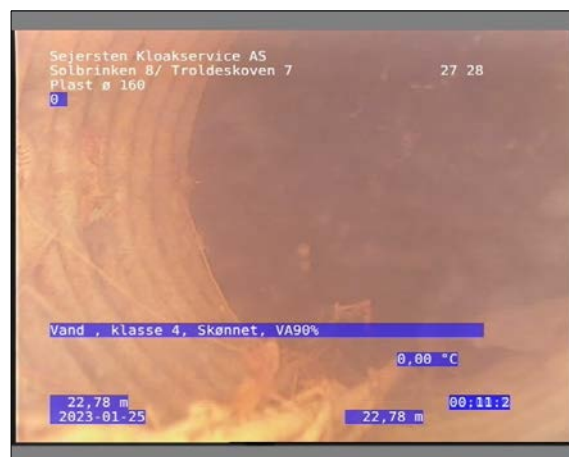
Foto: 20_1_21_25012023_125000_1.JPG 22,78m, Vand , klasse 4 / Skønnet, VA90%
