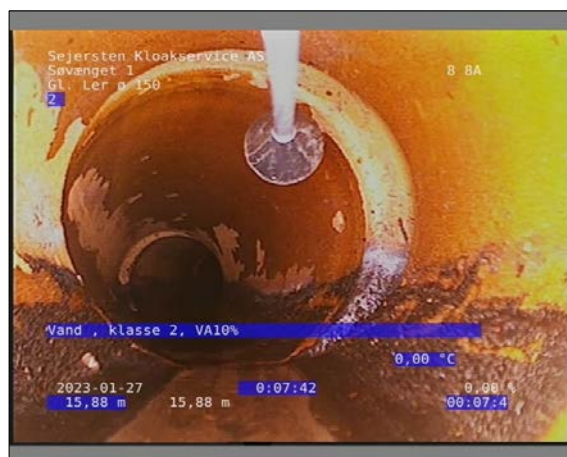
Foto: 28_1_19_27012023_103537_1.JPG 15,88m, Vand , klasse 2 / VA10%
