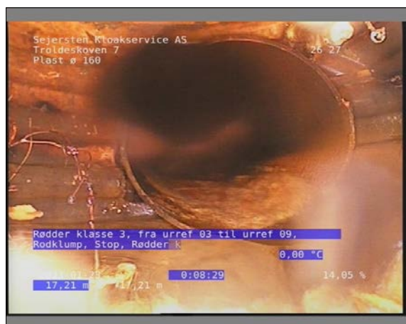
Foto: 10_1_15_23012023_145718_1.JPG 17,21m, Rødder klasse 3, fra urref 03 til urref 09, Rodklump, Stop / Rødder kommer ind i lednig via sandfang brønd
