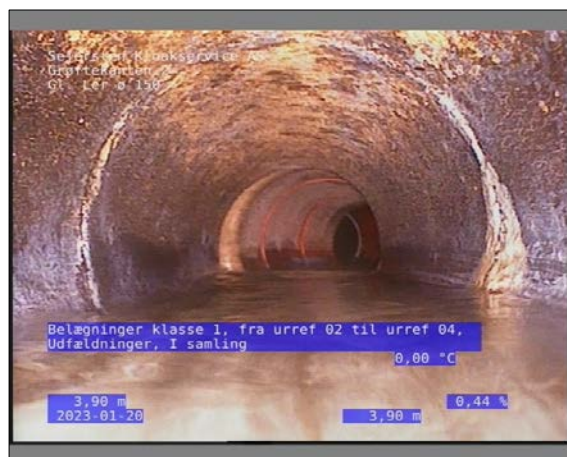
Foto: 4_1_8_20012023_102520_1.JPG 3,9m, Belægninger klasse 1, fra urref 02 til urref 04, Udfældninger, I samling
