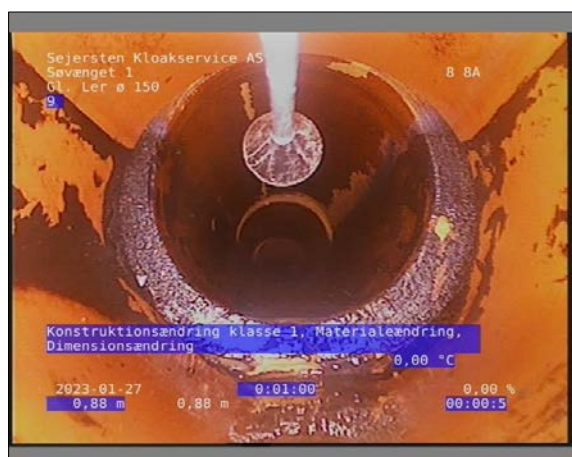
Foto: 28_1_4_27012023_102546_1.JPG 0,88m, Konstruktionsændring klasse 1, Materialeændring, Dimensionsændring
