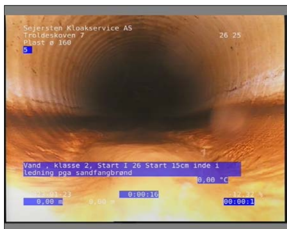
Foto: 9_1_1_23012023_140254_1.JPG 0m, Vand , klasse 2 / Start I 26 Start 15cm inde i ledning pga sandfangbrønd
