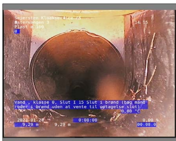
Foto: 13_1_19_24012023_100824_1.JPG 9,29m, Vand, klasse 0 / Slut I 15 Slut i brønd (bag mand roder i brønd uden at vente til optagelse slut)
