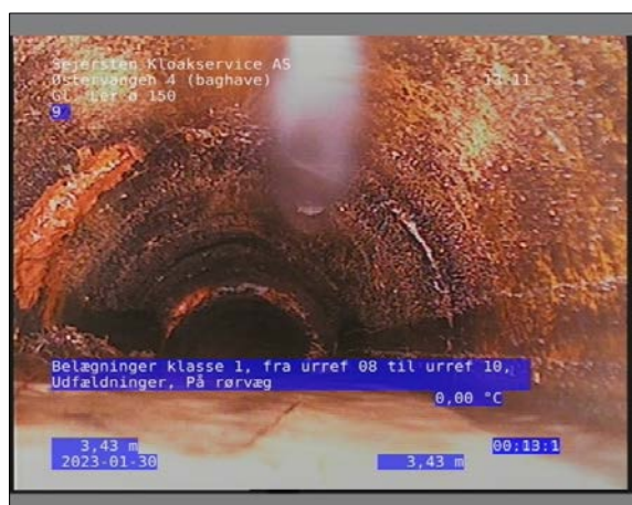
Foto: 31_1_18_30012023_142155_1.JPG 3,43m, Belægninger klasse 1, fra urref 08 til urref 10, Udfældninger, På rørvæg
