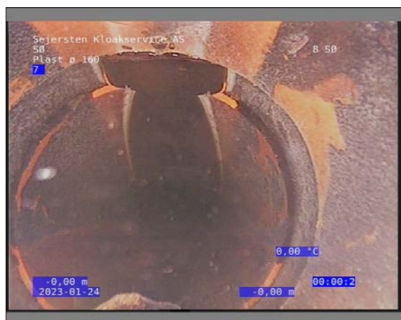
Foto: 16_1_4_24012023_134843_2.JPG 0,01m, FS4, Åben samling
