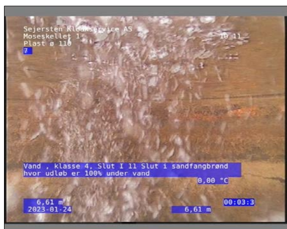
Foto: 12_1_10_24012023_083548_1.JPG 6,6m, Vand, klasse 4 / Slut I 11 Slut i sandfangbrønd hvor udløb er 100% under vand
