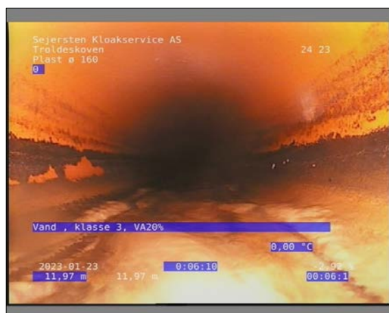
Foto: 8_1_12_23012023_132542_1.JPG 11,97m, Vand, klasse 3 / VA20%
