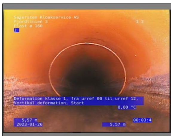
Foto: 24_1_8_26012023_101618_1.JPG 5,57m, Deformation klasse 1, fra urref 00 til urref 12, Vertikal deformation, Start
