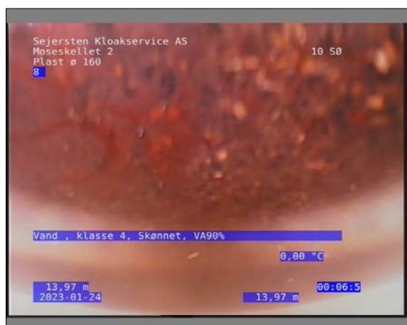
Foto: 11_1_12_24012023_080904_1.JPG 13,97m, Vand , klasse 4 / Skønnet, VA90%
