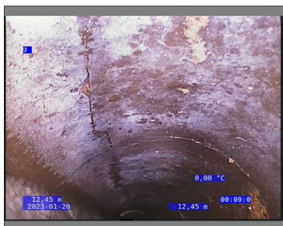
Foto: 3_1_18_20012023_094904_2.JPG 12,38m, Rørbrud klasse 2, fra urref 08 til urref 09, Langsgående revne langs røraksen
