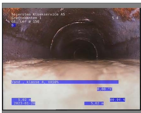
Foto: 3_1_11_20012023_094134_1.JPG 5,01m, Vand , klasse 4 / VA50%
