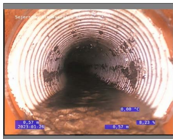
Foto: 23_1_6_26012023_094031_1.JPG 0,57m, Konstruktionsændring klasse 2, Materialeændring, Dimensionsændring / Ledningen overgår til drænrør
