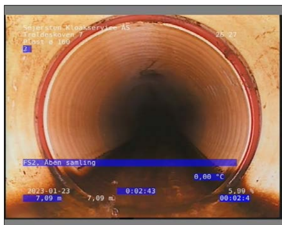
Foto: 10_1_6_23012023_144655_1.JPG 7,09m, FS2, Åben samling
