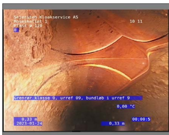
Foto: 12_1_4_24012023_083126_1.JPG 0,33m, Grenrør klasse 0, urref 09 / bundløb i urref 9
