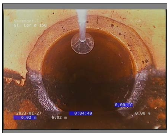
Foto: 28_1_12_27012023_103131_1.JPG 6,02m, FS3, Åben samling
