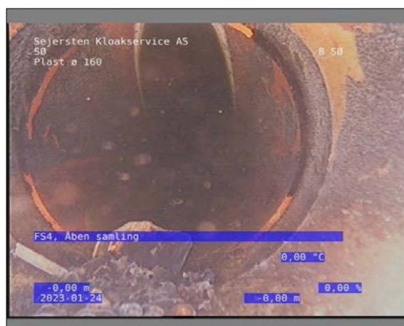
Foto: 16_1_4_24012023_134837_1.JPG 0,01m, FS4, Åben samling
