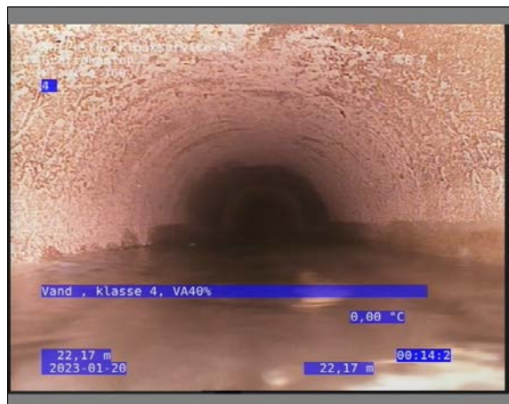
Foto: 4_1_26_20012023_104202_1.JPG 22,17m, Vand , klasse 4 / VA40%
