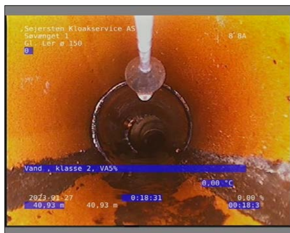
Foto: 28_1_43_27012023_105326_1.JPG 40,93m, Vand , klasse 2 / VA5%
