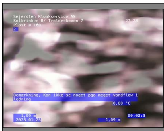
Foto: 20_1_8_25012023_123451_1.JPG 1,09m, Bemærkning / Kan ikke se noget pga meget vandflow i ledning
