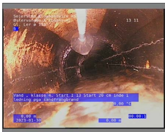
Foto: 31_1_1_30012023_135831_1.JPG 0m, Vand, klasse 4 / Start I 13 Start 20 cm inde i ledning pga sandfrangbrønd
