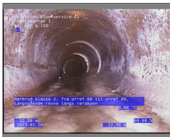
Foto: 3_1_18_20012023_094853_1.JPG 12,38m, Rørbrud klasse 2, fra urref 08 til urref 09, Langsgående revne langs røraksen
