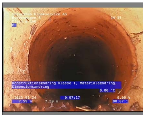
Foto: 13_1_17_24012023_100537_1.JPG 7,6m, Konstruktionsændring klasse 1, Materialeændring, Dimensionsændring
