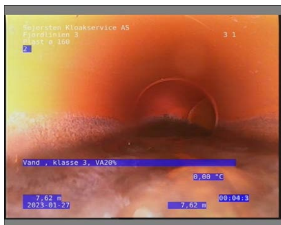
Foto: 25_1_10_27012023_084859_1.JPG 7,62m, Vand , klasse 3 / VA20%
