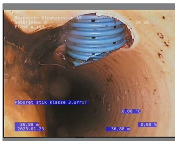
Foto: 19_1_13_25012023_111700_1.JPG 36,88m, Påboret stik klasse 3, urref 09, Indragende stik / Indravnede drænrør - bundløb i urref 9
