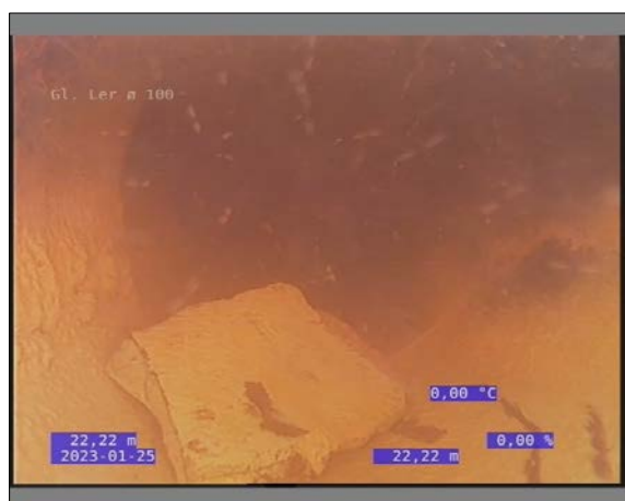
Foto: 17_1_20_25012023_092038_1.JPG 22,22m, Forhindring klasse 3, fra urref 03 til urref 09, Genstand i bundløb / Skønner løs rørs kald i ledning
