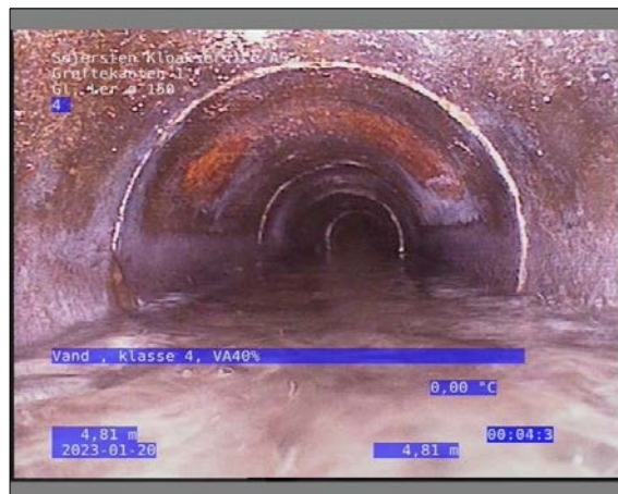
Foto: 3_1_10_20012023_094115_1.JPG 4,81m, Vand , klasse 4 / VA40%
