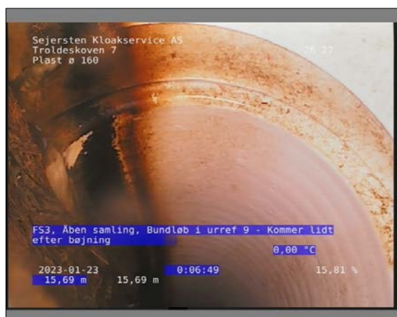
Foto: 10_1_12_23012023_145410_1.JPG 15,69m, FS3, Åben samling / Bundløb i urref 9 - Kommer lidt efter bøjning
