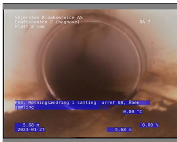
Foto: 26_1_8_27012023_092921_1.JPG 5,67m, FS3, Retningsændring i samling urref 08, Åben samling
