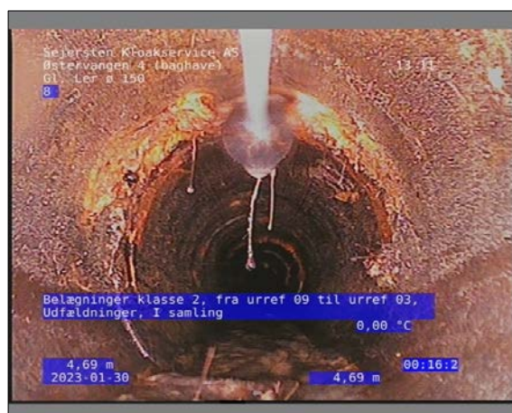
Foto: 31_1_23_30012023_142700_1.JPG 4,69m, Belægninger klasse 2, fra urref 09 til urref 03, Udfældninger, I samling
