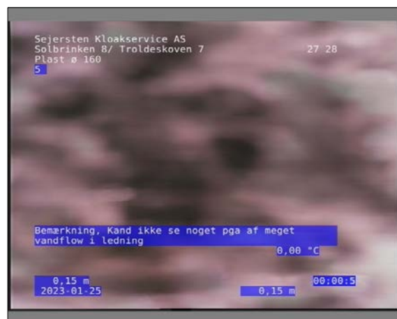
Foto: 20_1_3_25012023_123101_1.JPG 0,15m, Bemærkning / Kand ikke se noget pga af meget vandflow i ledning
