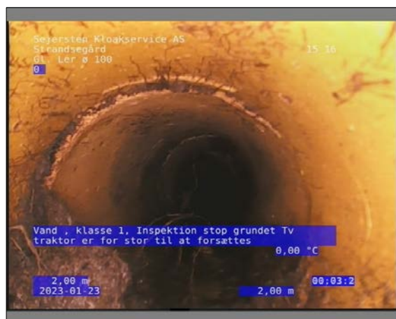
Foto: 5_1_8_23012023_084535_1.JPG 2m, Vand , klasse 1 / Inspektion stop grundet Tv traktor er for stor til at forsættes
