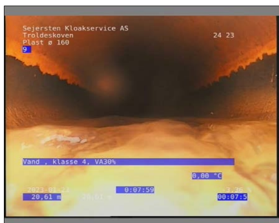
Foto: 8_1_14_23012023_132801_1.JPG 20,61m, Vand , klasse 4 / VA30%
