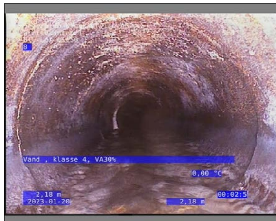
Foto: 3_1_6_20012023_093852_1.JPG 2,18m, Vand , klasse 4 / VA30%
