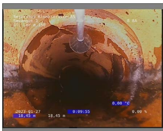
Foto: 28_1_24_27012023_103933_1.JPG 18,45m, Rørbrud klasse 4, fra urref 00 til urref 12, Sammensatte revner, Start
