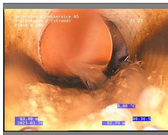
Foto: 22_1_39_26012023_091130_1.JPG 63,4m, Konstruktionsændring klasse 2, Dimensionsændring, Retningsændringer urref 09 / 30 grader skønnet - Tilløb rør er skubbet ind i ledning og rundt om tilbøb er der udsyn til brønd - Fejl i metermål på skærmttekst skal være 63,40m
