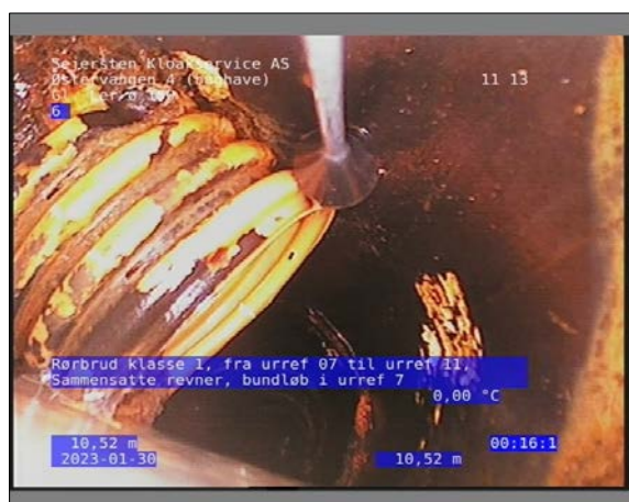
Foto: 30_1_23_30012023_131730_1.JPG 10,52m, Rørbrud klasse 1, fra urref 07 til urref 11, Sammensatte revner / bundløb i urref 7
