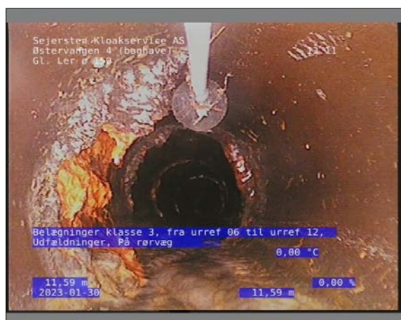
Foto: 31_1_32_30012023_143253_1.JPG 11,59m, Belægninger klasse 3, fra urref 06 til urref 12, Udfældninger, På rørvæg
