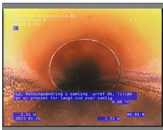
Foto: 24_1_6_26012023_101216_1.JPG 2,51m, FS2, Retningsændring i samling urref 06 / Tilløb rør er presset for langt ind over samlig
