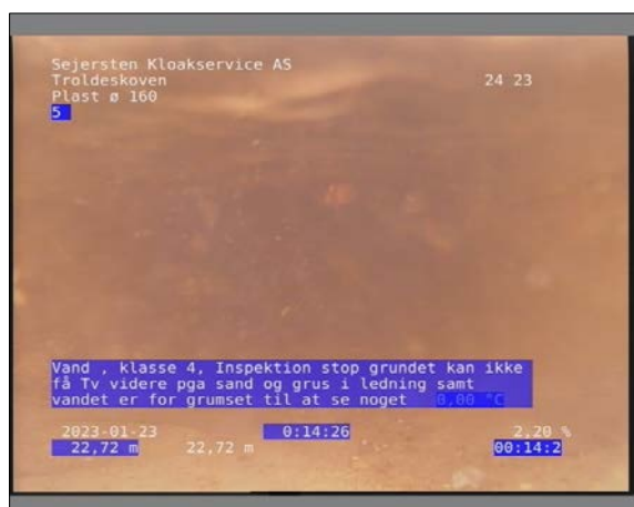
Foto: 8_1_16_23012023_133728_1.JPG 22,74m, Vand, klasse 4 / Inspektion stop grundet kan ikke få Tv videre pga sand og grus i ledning samt vandet er for grumset til at se noget
