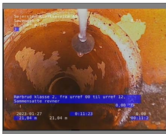
Foto: 28_1_27_27012023_104236_1.JPG 21,04m, Rørbrud klasse 2, fra urref 00 til urref 12, Sammensatte revner
