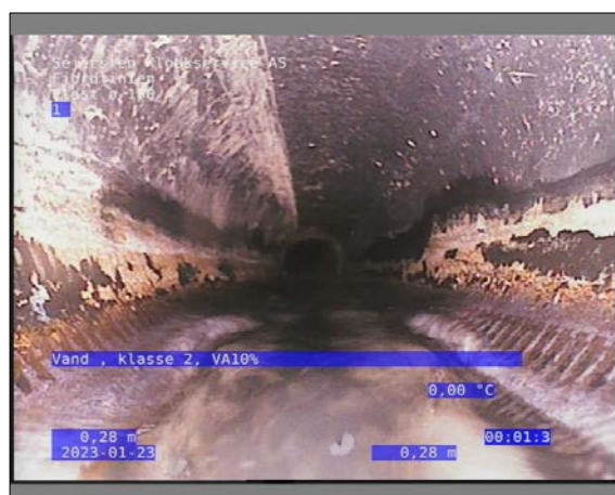
Foto: 7_1_5_23012023_112807_1.JPG 0,28m, Vand , klasse 2 / VA10%
