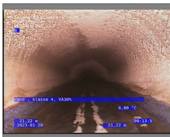
Foto: 4_1_24_20012023_104121_1.JPG 21,22m, Vand , klasse 4 / VA30%
