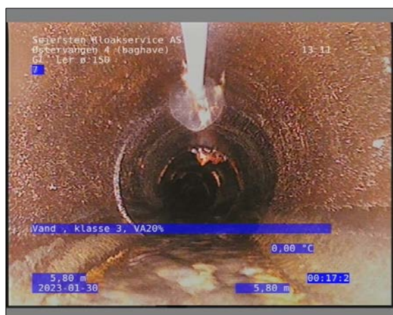
Foto: 31_1_27_30012023_142855_1.JPG 5,8m, Vand, klasse 3 / VA20%
