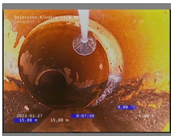
Foto: 28_1_20_27012023_103557_1.JPG 15,88m, FS3, Retningsændring i samling urref 09, Åben samling
