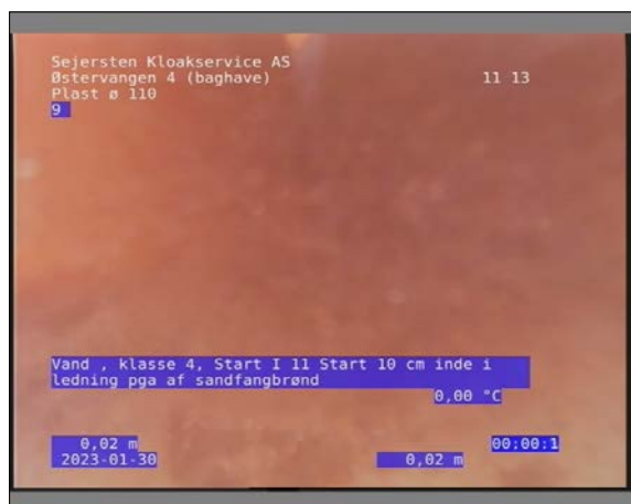
Foto: 30_1_1_30012023_124606_1.JPG 0,02m, Vand, klasse 4 / Start I 11 Start 10 cm inde i ledning pga af sandfangbrønd
