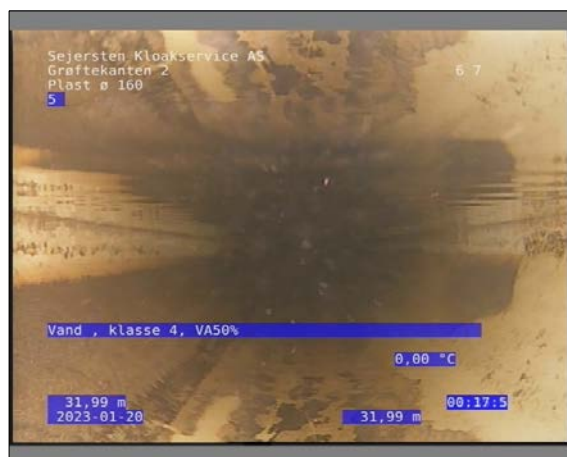
Foto: 4_1_31_20012023_104605_1.JPG 31,99m, Vand , klasse 4 / VA50%
