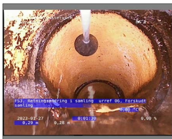
Foto: 29_1_6_27012023_113126_1.JPG 0,29m, FS3, Retningsændring i samling urref 06, Forskudt samling
