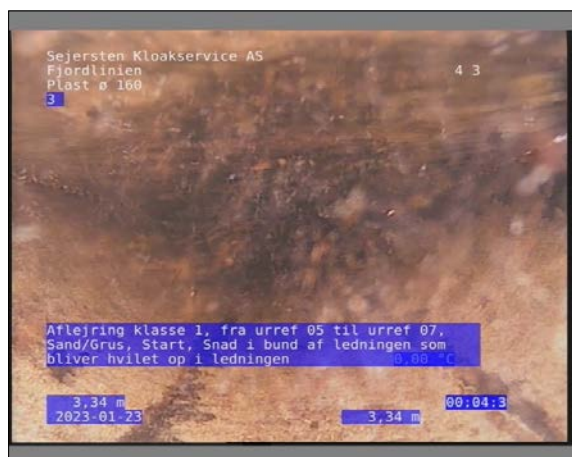
Foto: 7_1_10_23012023_113920_1.JPG 3,34m, Aflejringsklasse 1, fra urref 05 til urref 07, Sand/Grus, Start / Sned i bund af ledningen som bliver hvilet op i ledningen
