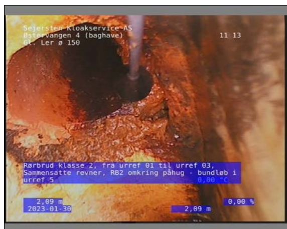
Foto: 30_1_13_30012023_130622_1.JPG 2,09m, Rørbrud klasse 2, fra urref 01 til urref 03, Sammensatte revner / RB2 omkring påhug - bundløb i urref 5
