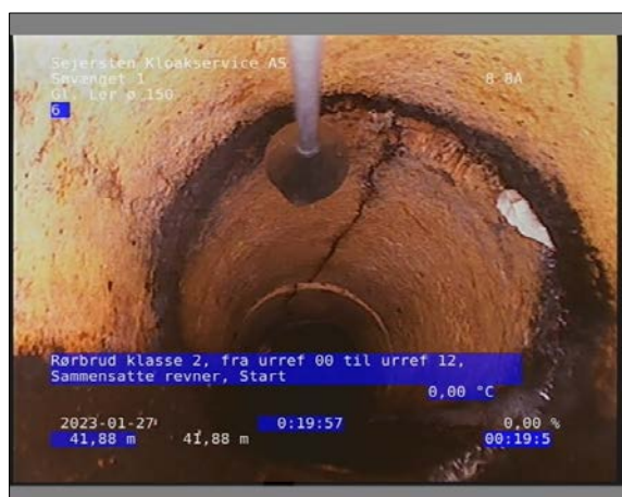
Foto: 28_1_44_27012023_105507_1.JPG 41,88m, Rørbrud klasse 2, fra urref 00 til urref 12, Sammensatte revner, Start
