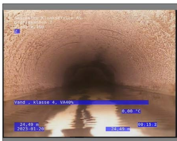
Foto: 4_1_28_20012023_104313_1.JPG 24,49m, Vand , klasse 4 / VA40%
