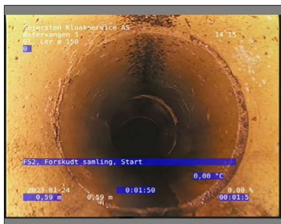
Foto: 13_1_6_24012023_095618_1.JPG 0,59m, FS2, Forskudt samling, Start
