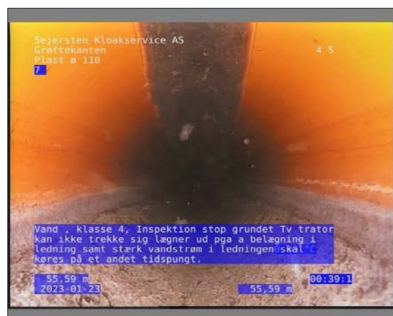
Foto: 6_1_28_23012023_110756_1.JPG 55,59m, Vand , klasse 4 / Inspektion stop grundet Tv trator kan ikke trekke sig lægner ud pga a belægning i ledning samt stærk vandstrøm i ledningen skal køres på et andet tidspunkt.
