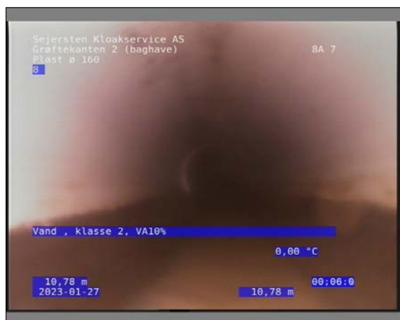
Foto: 26_1_11_27012023_093154_1.JPG 10,78m, Vand, klasse 2 / VA10%
