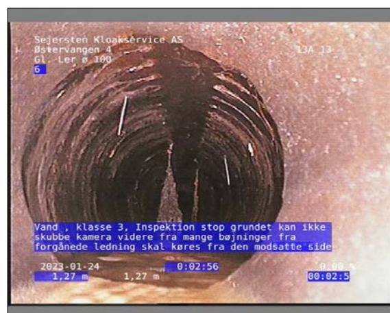
Foto: 15_1_6_24012023_121130_1.JPG 1,27m, Vand , klasse 3 / Inspektion stop grundet kan ikke skubbe kamera videre fra mange bøjninger fra forgåede ledning skal køres fra den modsatte side
